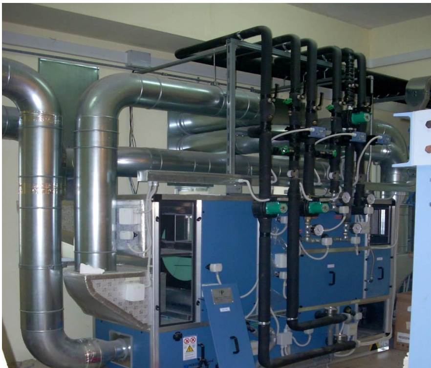
Figura 1. Unità di Trattamento Aria dotata di ruota essiccante
