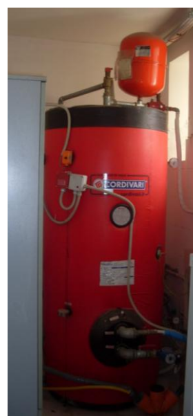
Figura 8. Serbatoio di accumulo
