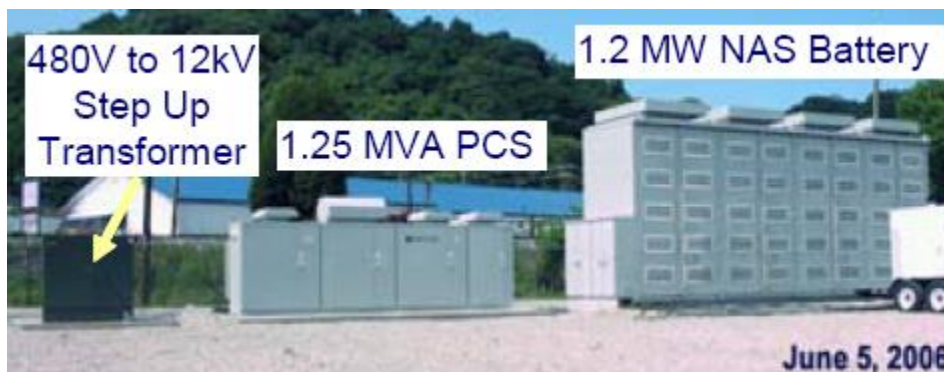
Figura 6. Batteria sodio-zolfo (Na/S) installata dall'AEP in Virginia (USA) nel 2006.
