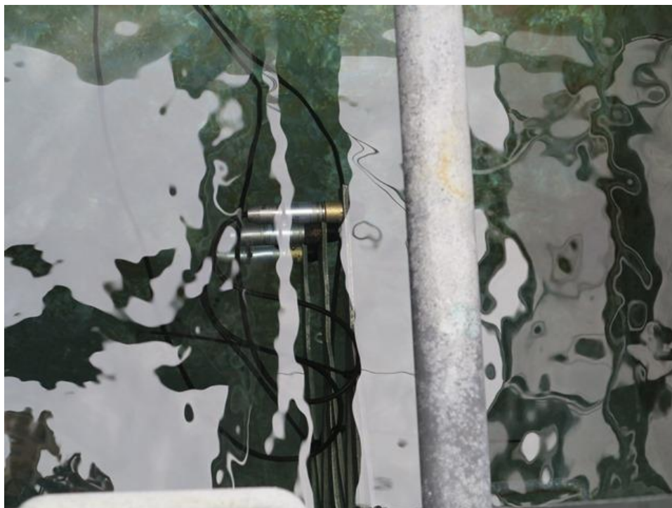
Figura 8b. Trasduttori di pressione montati nella camera di assorbimento del REWEC3-GV.
