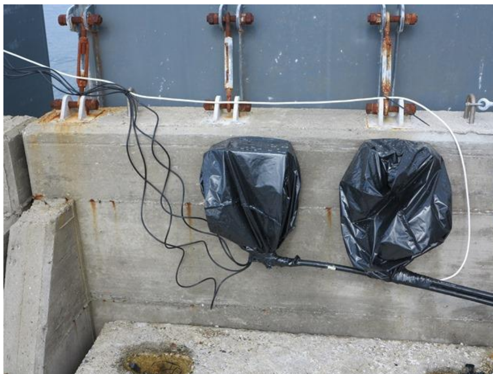
Figura 6. Particolare del cassone REWEC3-GV: cassette per connessione degli strumenti.
