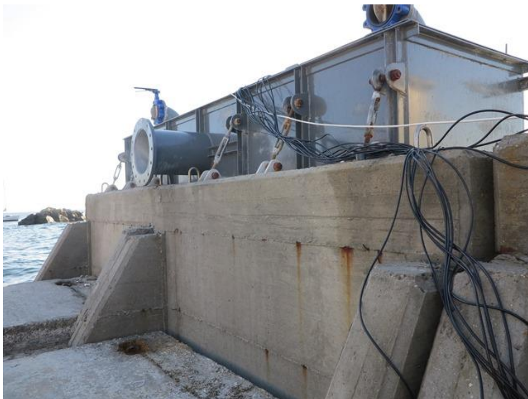
Figura 11a. REWEC3-GV con i coperchi e le valvole a farfalla; lo sfiato è relativo alla camera centrale.
