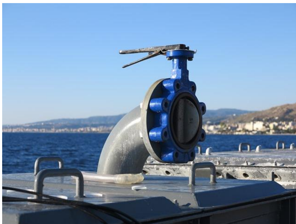
Figura 11b. REWEC3-GV: particolare della valvola a farfalla nella camera NORD.
