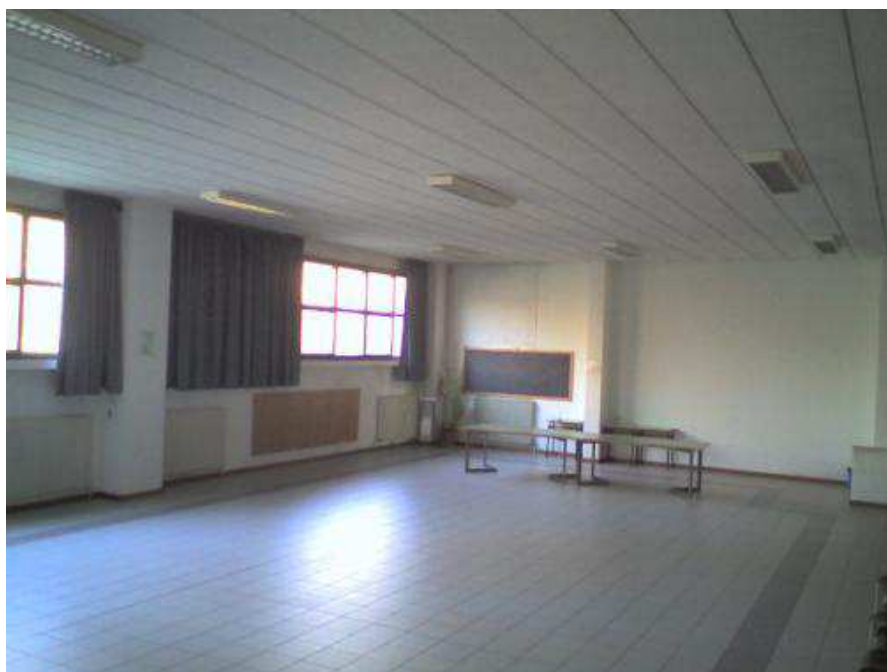
Figura 1 Aula Magna immagine termografica e fotografica
