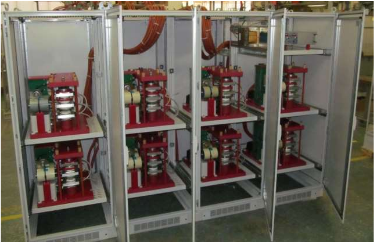
Figura 13. Armadio SCB, dal lato "stack" accessibile tramite portelle. Sono visibili gli otto moduli in parallelo.
