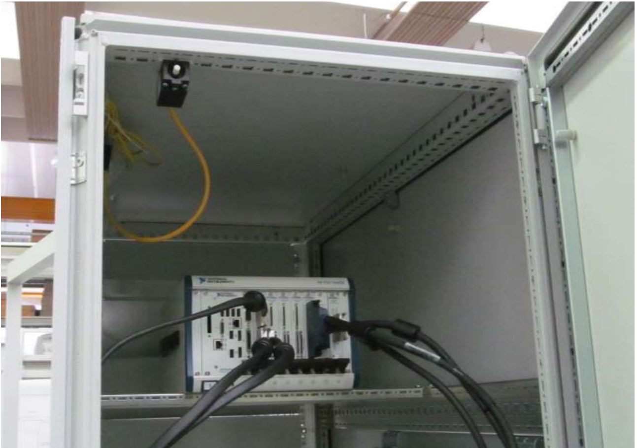
Figura 21. Dettaglio dell'armadio LCC in cui è visibile il sistema PXI che costituisce il cuore del controllo degli SNU. Attualmente il controllore LCC è dedicato solo al prototipo. Dopo la costruzione degli ulteriori 3 SNU, questo sistema sarà aggiornato per controllare tutti e 4 gli SNU.
