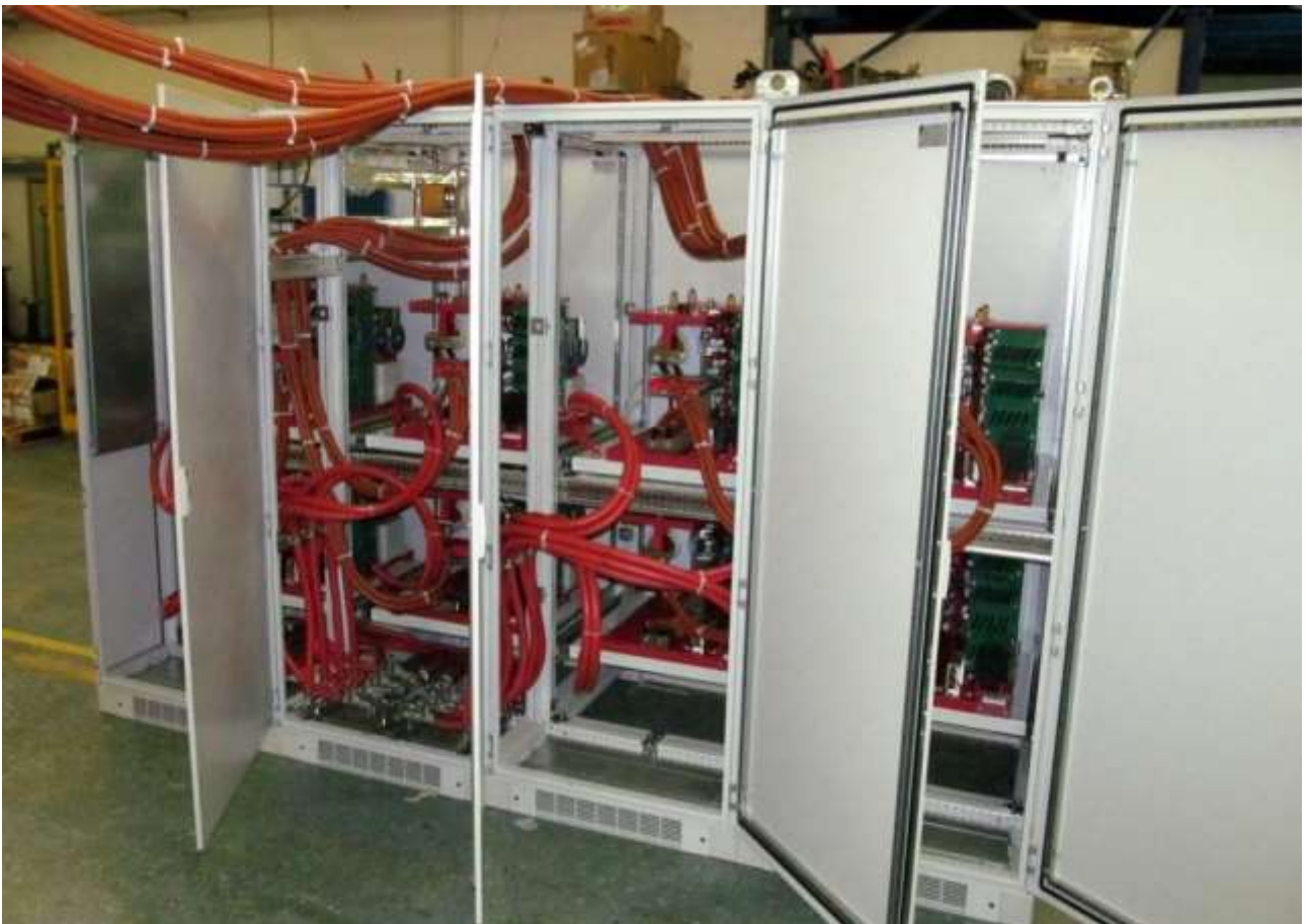
Figura 14. Armadio SCB, dal lato del circuito idraulico di raffreddamento ad acqua demineralizzata.
