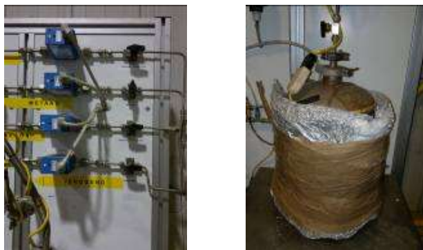
Figura 3 - Mass-flow gas e contenitore MTS
