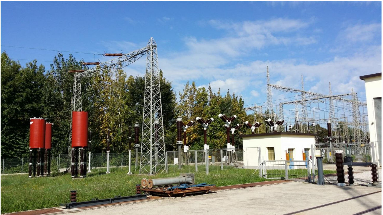
Figura 19. Una parte della sottostazione elettrica sfruttata per produrre i 41 kA di corrente necessari ad effettuare le prove di resistenza elettrodinamica del BPS.
