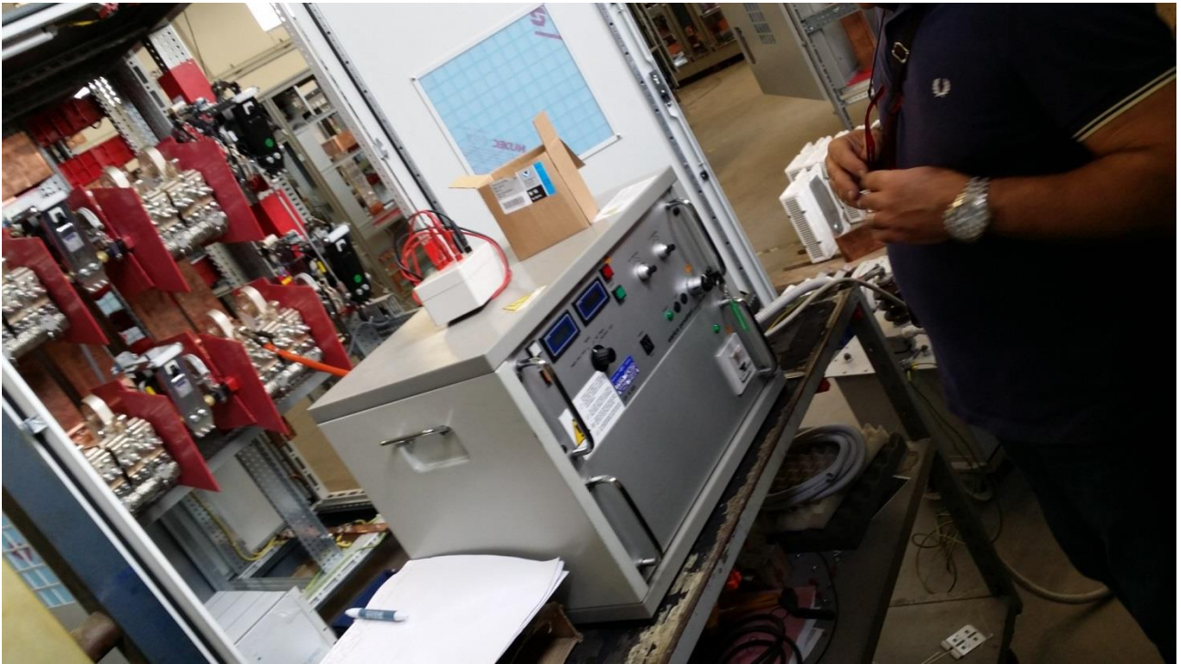
Figura 12. Un momento del test di isolamento sull'armadio finale del BPS. È visibile il generatore di test a 20 kV per 60 s con controllo della corrente di dispersione.
