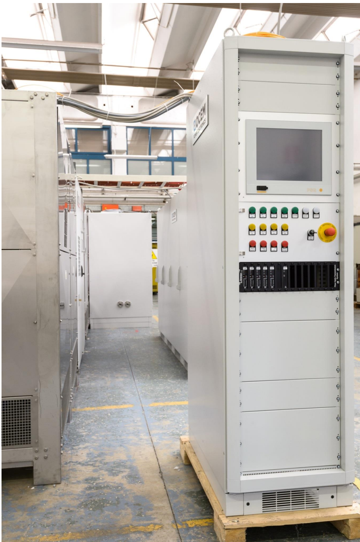
Figura 8. Foto dell'armadio LCC e della parte "interna" di manutenzione del prototipo.
