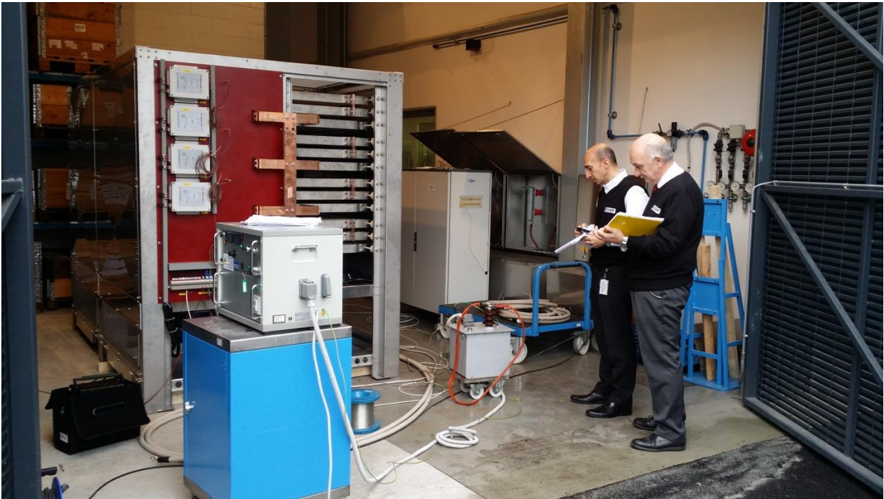
Figura 21. L'armadio di R2 durante il test di isolamento a 20 kV 50 Hz per 60 s.
