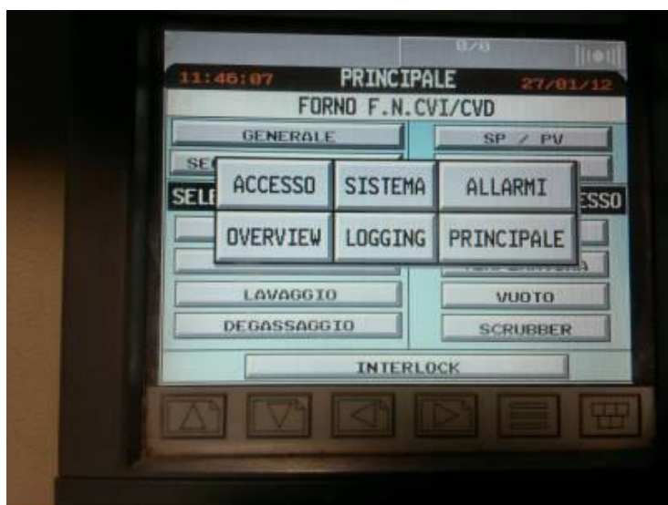
Figura 23. Display touch impianto CVI
