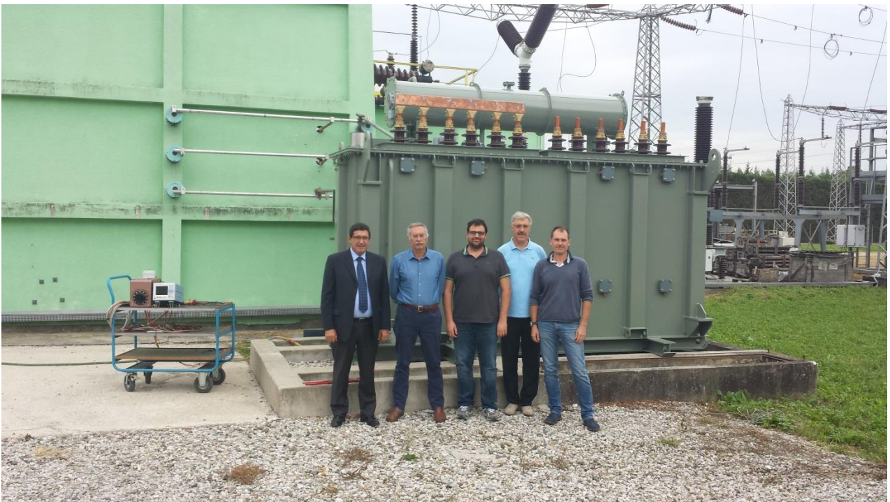
Figura 4 – Prova in corto circuito del trasformatore c/o SVEPPI (SIEMENS) Laboratory
