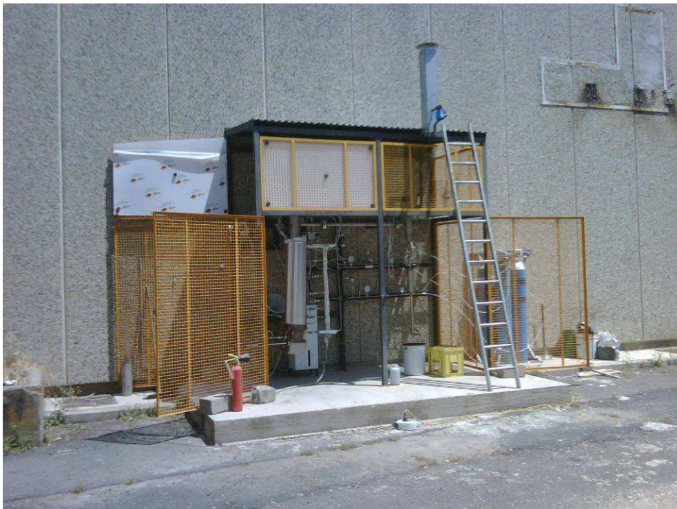
Fig. 1: Mini impianto di gassificazione GESSICA
