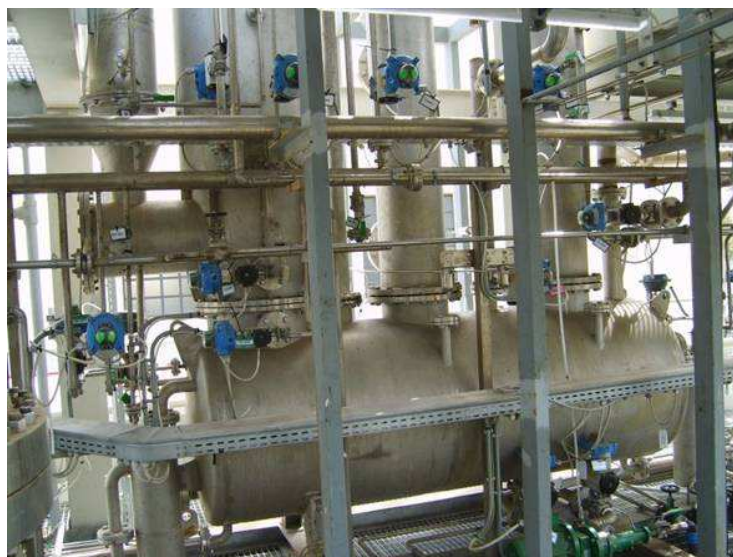
Figura 5 - Sezione di clean up, sono visibili da sx verso dx le tre colonne del WESP, del DeSox e dello Scrubber
