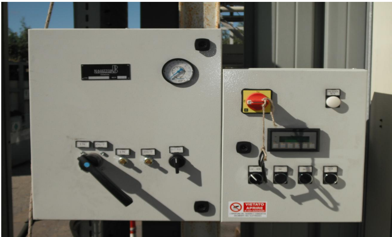
Foto11. pannello di controllo del pistone
