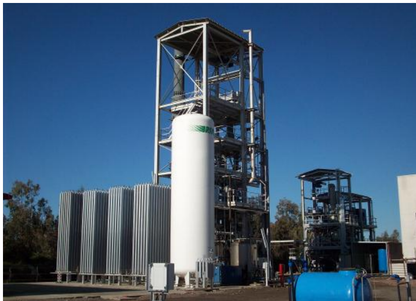
Figura 1.1. La piattaforma pilota Sotacarbo.
