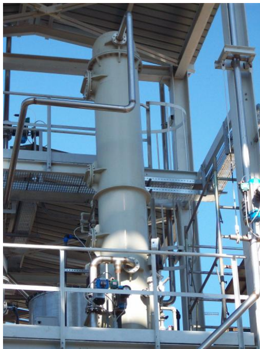
Figura 2.3. Colonna di desolfurazione a freddo del syngas.
