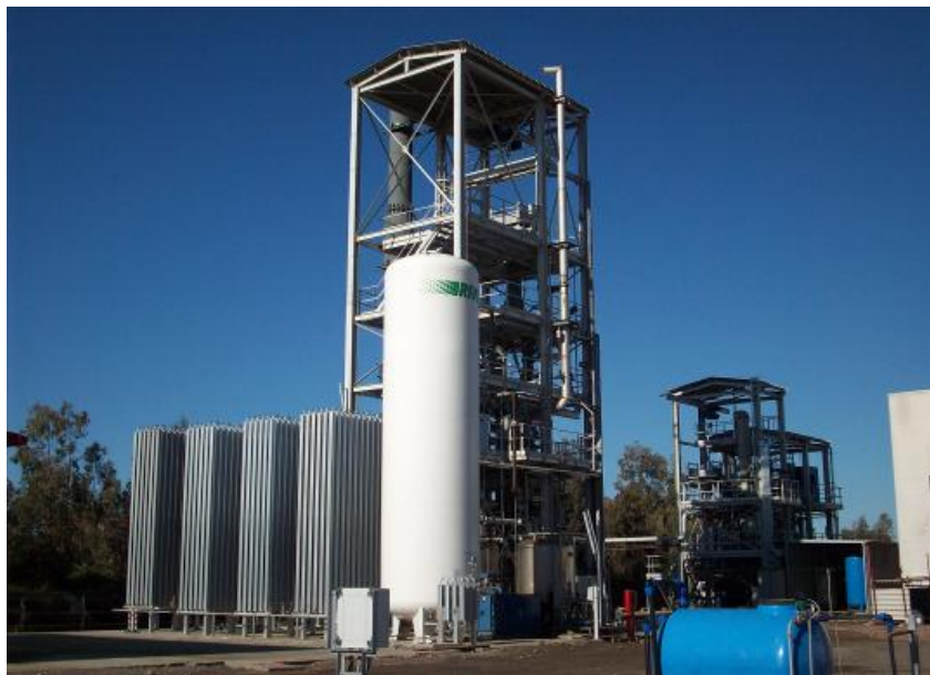
Figura 1.1. La piattaforma pilota Sotacarbo.
