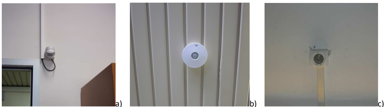
Figura 10: Rilevatori di presenza installati nell’edificio F40: a) VEMER 200, sensore installato negli uffici; b) VEMER 200, sensore installato nei corridoi e nei bagni; c) Altenburger MSD, sensore installato nella control room.
