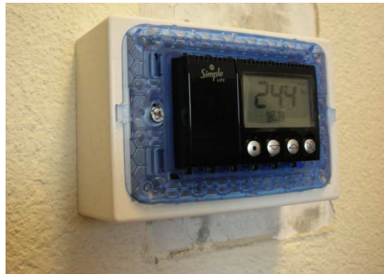
Figura 9: KRONO (Simple life-UMPI)- termostato ambiente installato in campo.
