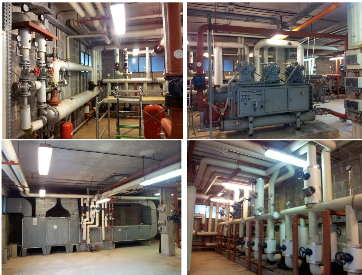
Figura 4: Immagini della centrale Termica dell'edificio F40. Nello specifico: a) scambiatore di calore; b) gruppo frigorifero; c) unità di trattamento aria; d) elettropompe
