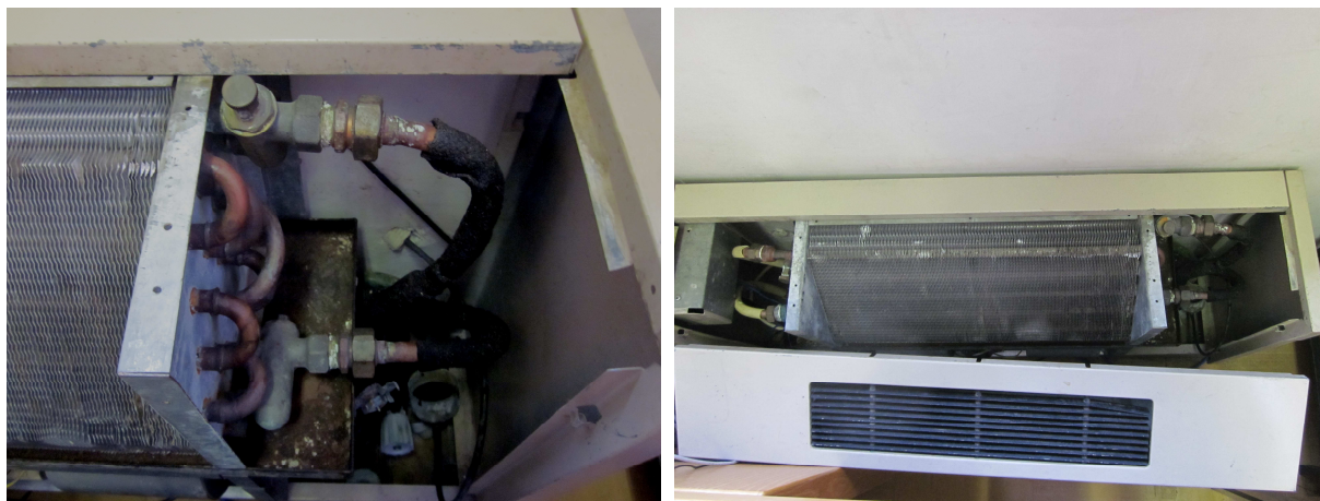
Figura 6: Terminali fancoils a 4 tubi installati negli uffici
