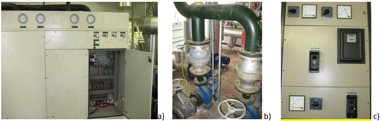
Figura 28: a) Gruppo frigorifero, b) elettropompe di circolazione e c) quadro elettrico in centrale termica
