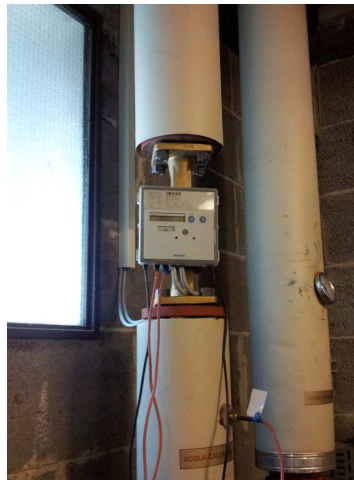
Figura 16: Contabilizzatore di calore installato sul tubo di mandata del circuito dei fancoils.
