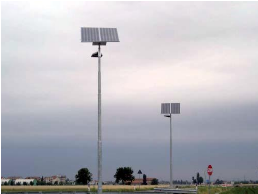
Figura 5.4 – Lampioni fotovoltaici presso variante di Pilastro Langhirano (Comune di Langhirano)
