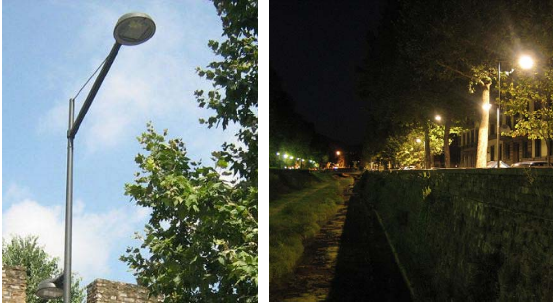
Figure 5.13 e 5.14 - A sinistra i tipi di pali impiegati per la realizzazione dell'intervento (Philips lighting e Silfi illuminazione), nell'immagine di destra il risultato di notte dell'impianto
