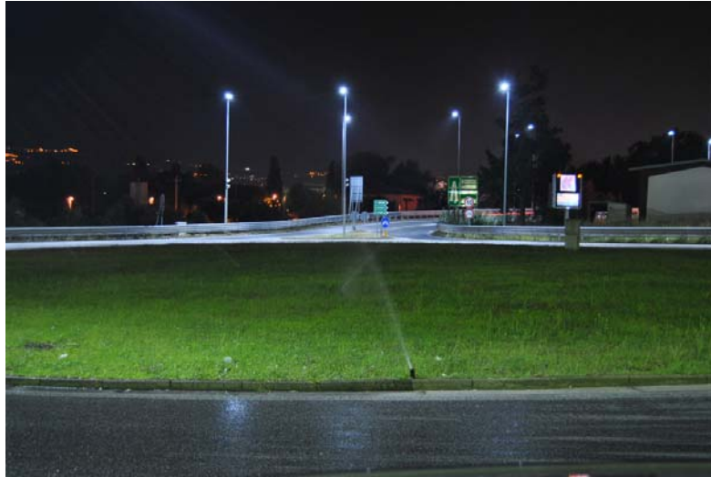
Fig. 5.17 - Risultato dell'illuminazione a LED dello svincolo per Cosenza sull'autostrada Salerno – Reggio Calabria (EIAESCO S.r.l.)
