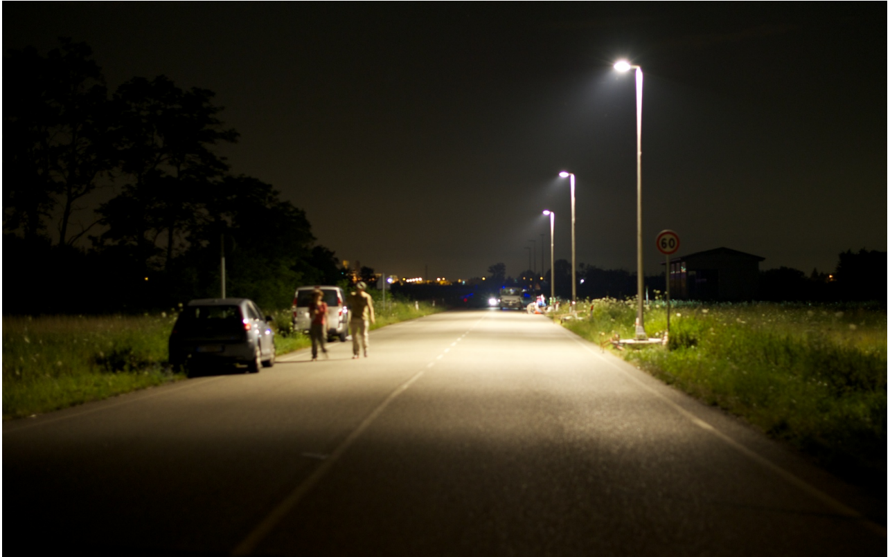
Figura 49 Impianto con apparecchio con vetro curvo e con lampada a ioduri metallici.
