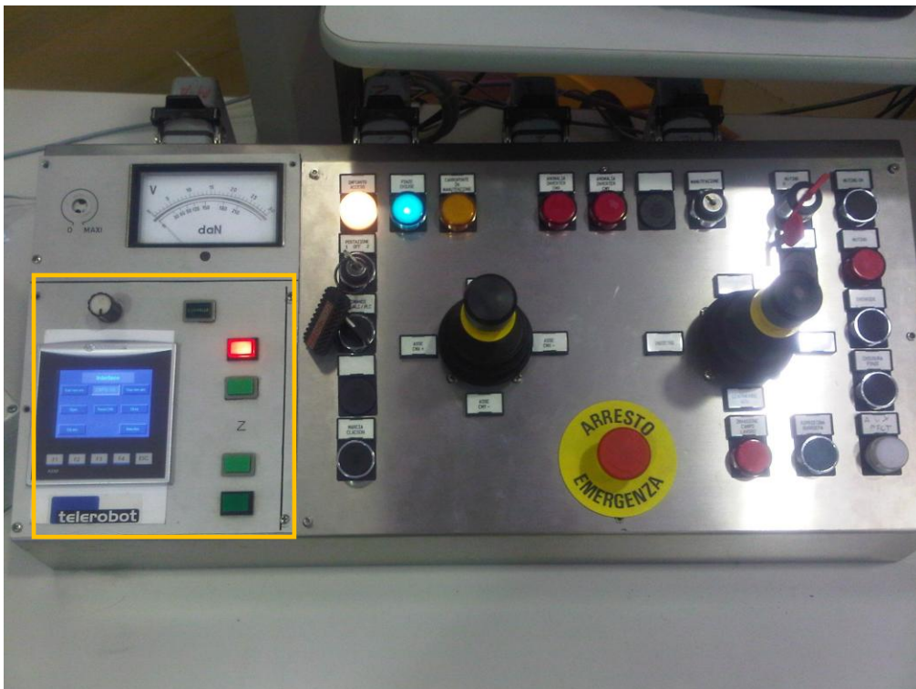
Fig. 13 Modifica pannello locale sala Controllo
