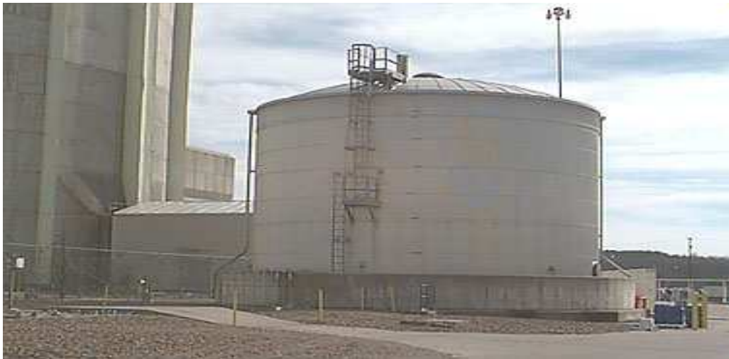
Figura 31 Serbatoio acqua di emergenza
