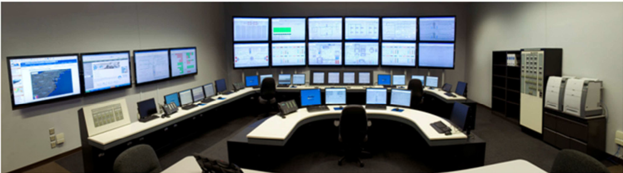
Figura 23 Simulatore Westinghouse di sala controllo dell'impianto AP1000
