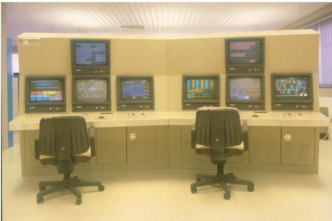
Figura 24 Console principale di comando del simulatore ingegneristico ES-1000 sviluppato da ENEA-Westinghouse per l'impianto PWR-PUN
