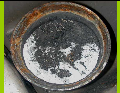
Sale parzialmente rimosso dopo lavaggio con acqua calda
