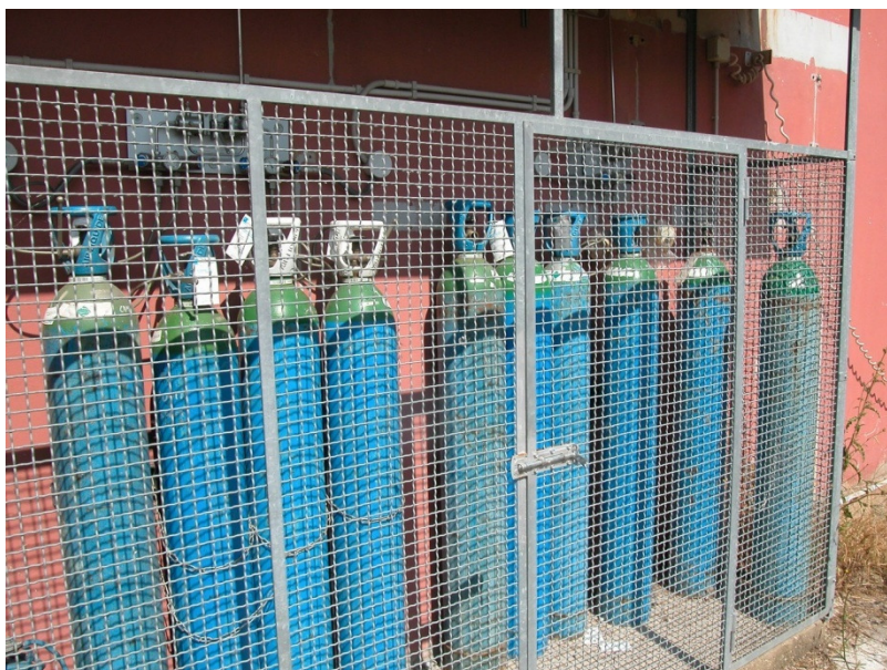
Parco bombole di Argon all'esterno dell'edificio che ospita l'impianto OGATA
