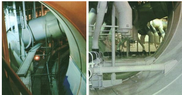
Figura 7. Dettagli del sistema di sfogo del vapore dal drywell alla piscina di soppressione.
