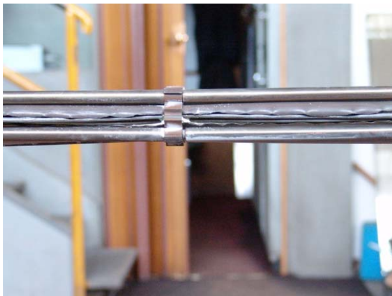
Figura 3 - Fascio di barre Rotfil Barra lesionata e particolare dei conduttori interni
