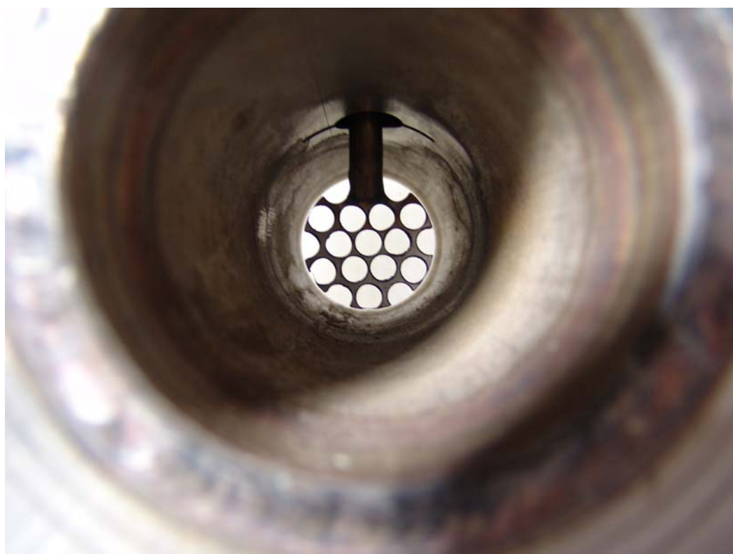
Figura 8: Disco all'interno della tubazione da 3''
