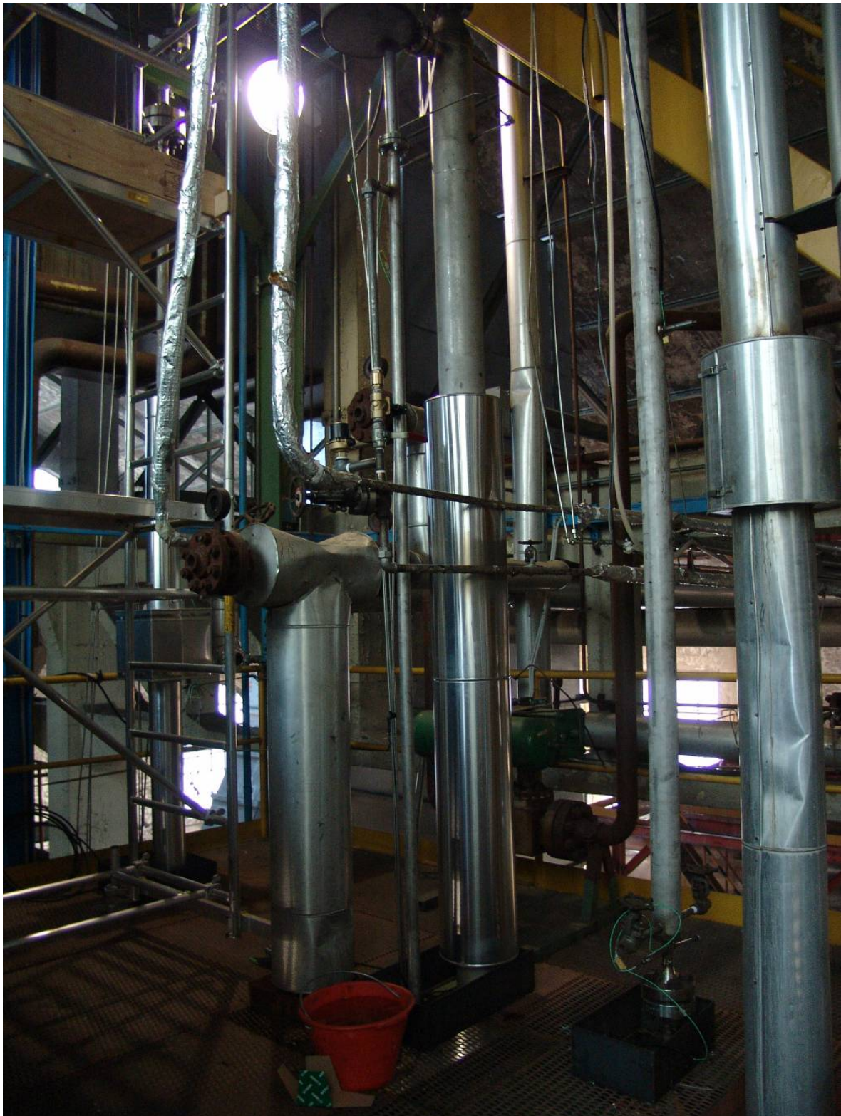
Fig. 3. 3 - Circuito prova barre – vista scambiatore principale
