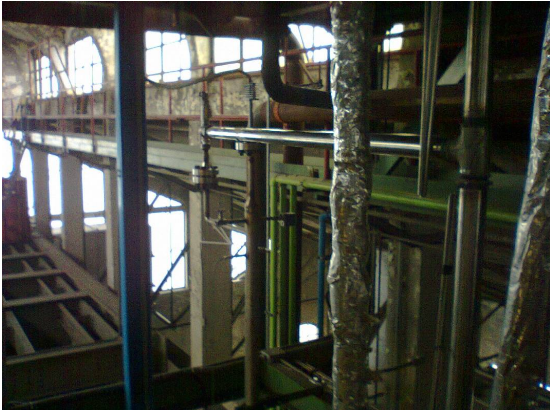
Fig. 3. 1 - Circuito prova barre: vista ramo superiore
