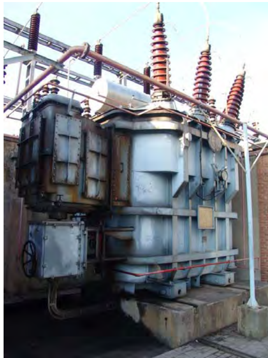
Figure 2 - Trasformatore TR2 130 / 3 kV
