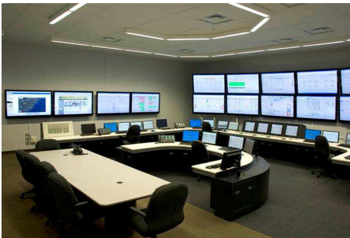
Fig. 2-1 Simulatore Westinghouse di sala controllo dell'impianto AP1000
