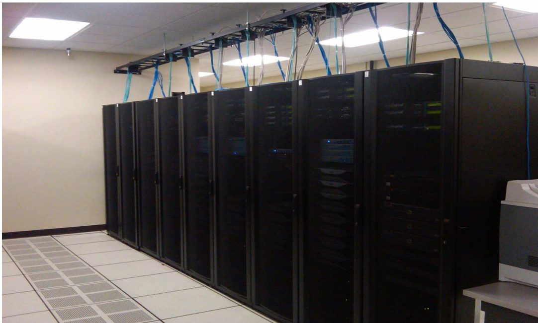
Fig. 3-6 Cabinet di alloggiamento dei PC del simulatore full scope Westinghouse AP1000
