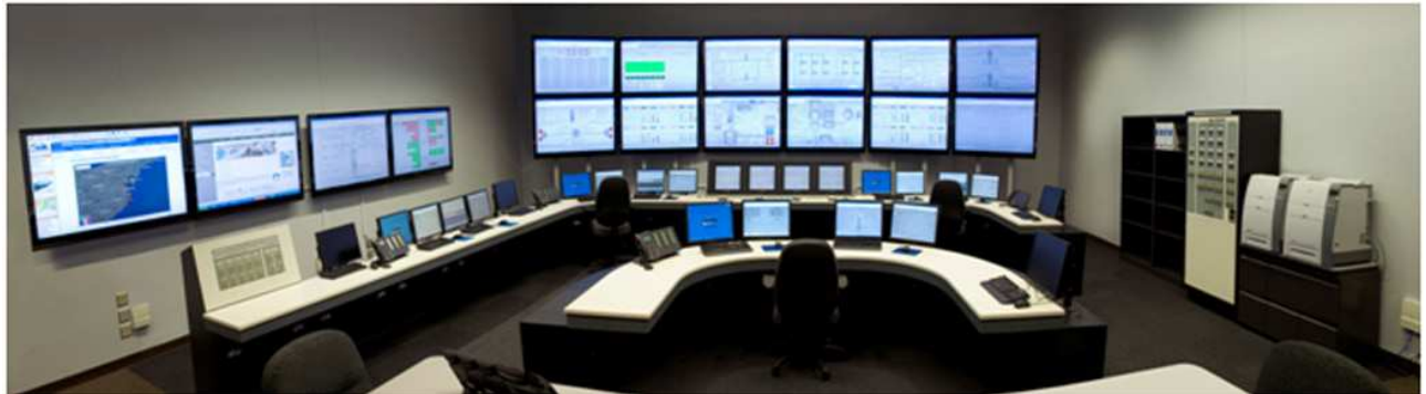
Fig. 2-1 Simulatore Westinghouse di sala controllo dell'impianto AP1000
