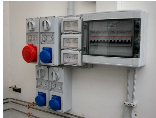
Prese elettriche a parete
