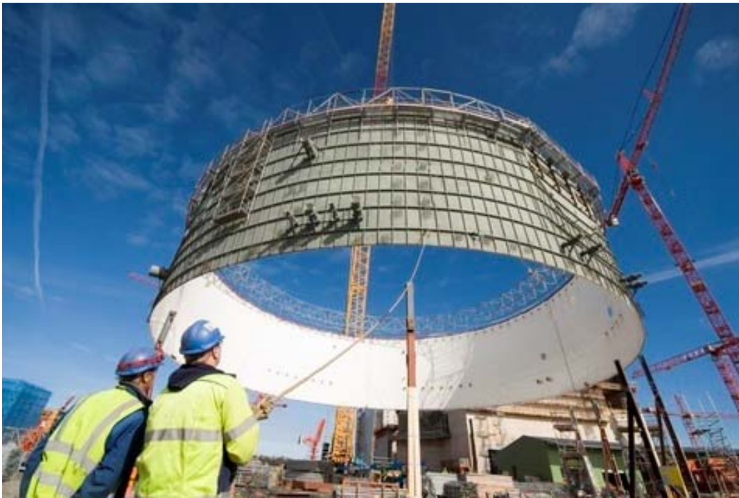
Figura 4 Steel liner (Galleria immagini da www.tvo.fi )
