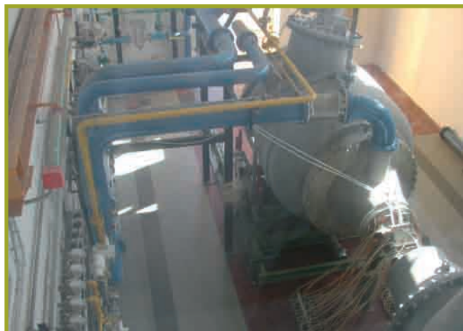
Locale impianto CERtem
