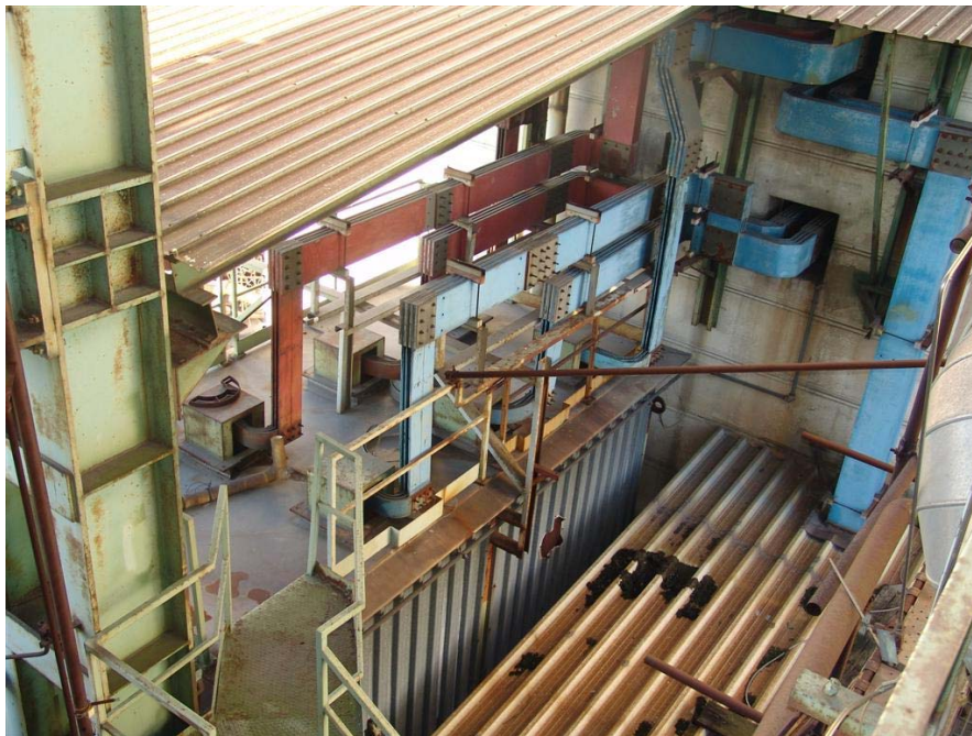
Figura n. 15 - Caldaia Elettrica Impianto GEST-GEN: vista dall'alto
