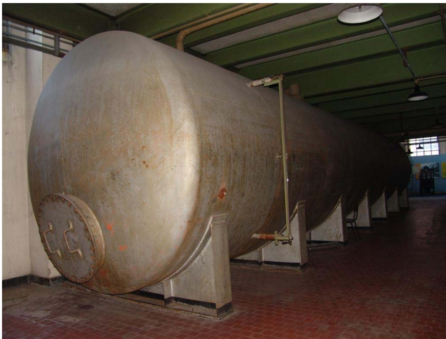
Figura n. 51 - Serbatoio Acqua Demineralizzata
