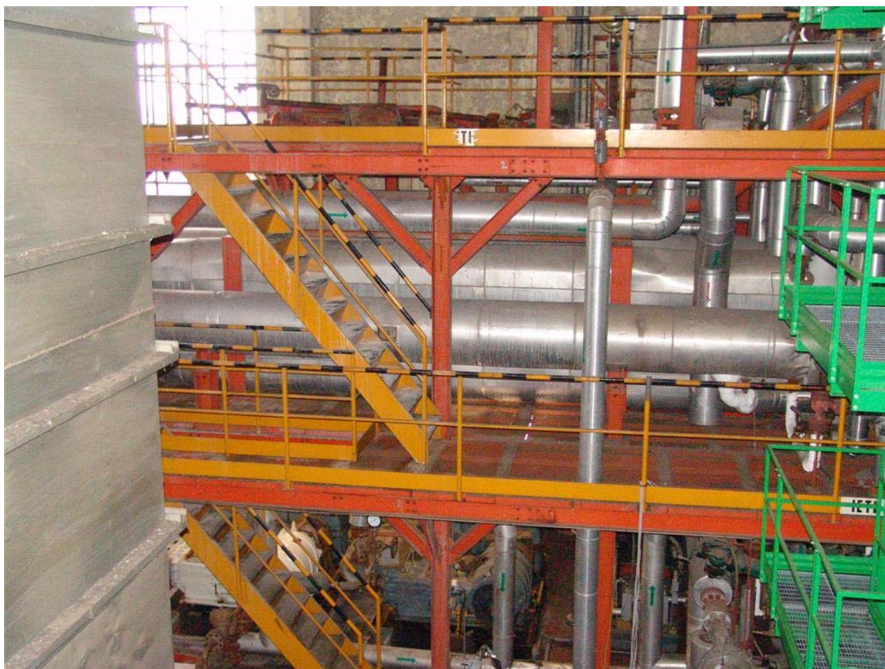
Figura n. 31 - Preriscaldatori Acqua impianto IETI-4
