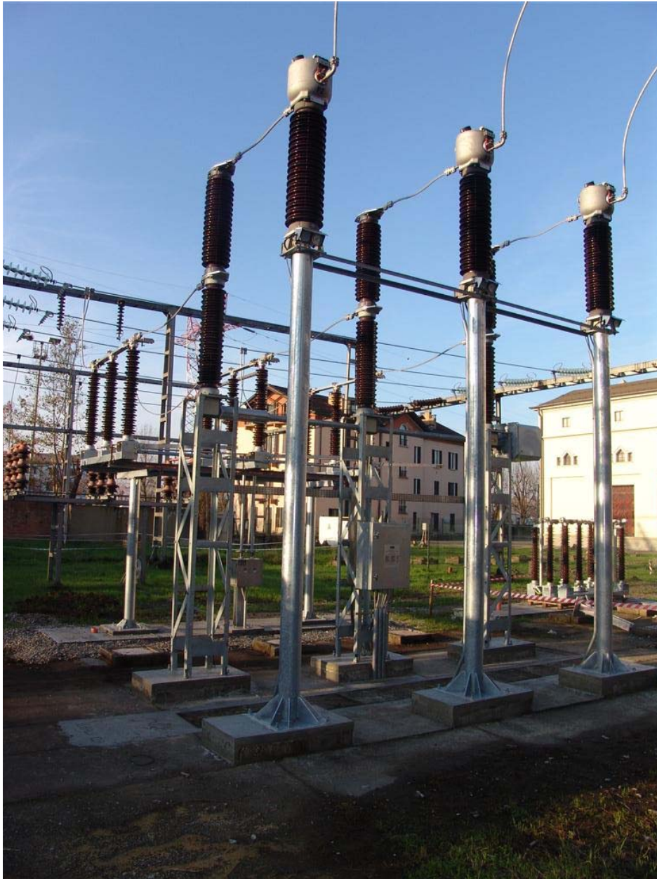
Figura n. 35 - Nuovi Interruttori e Sezionatori 130 kV
