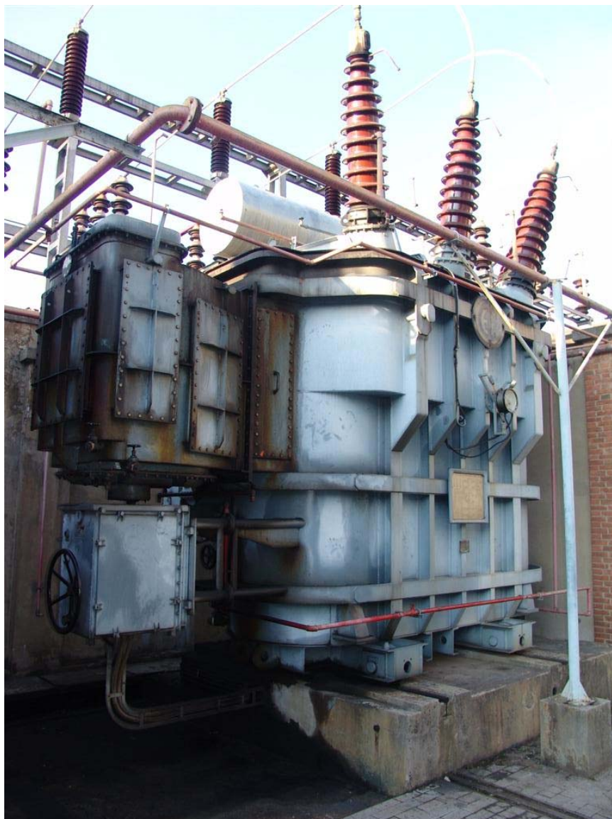
Figura n. 33 - Trasformatore 130 / 3 kV (CEM-2)
