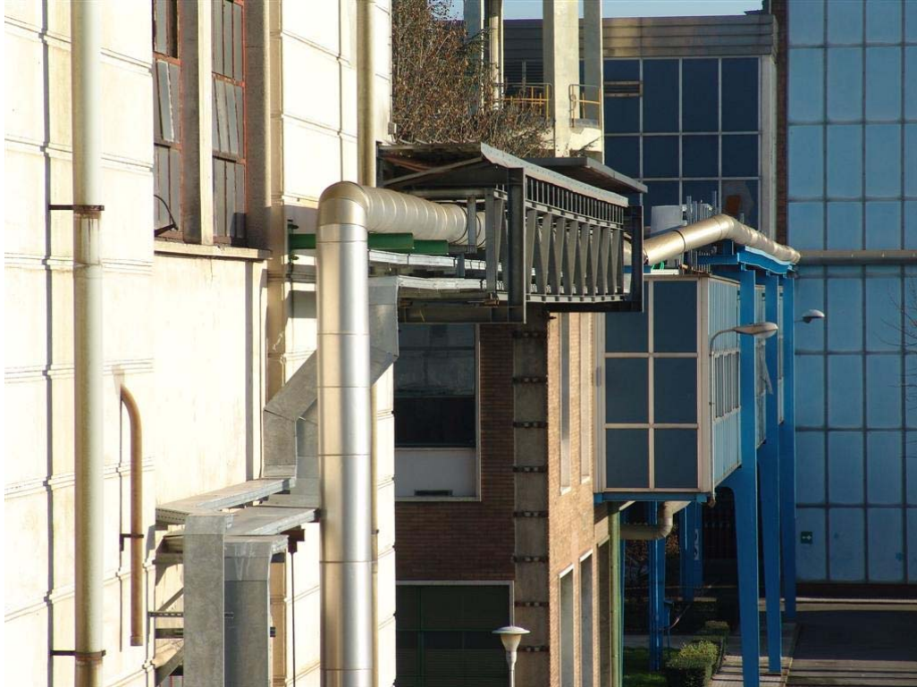
Figura n. 47 - Linea 5" Vapore Surriscaldato da Centrale Edipower
