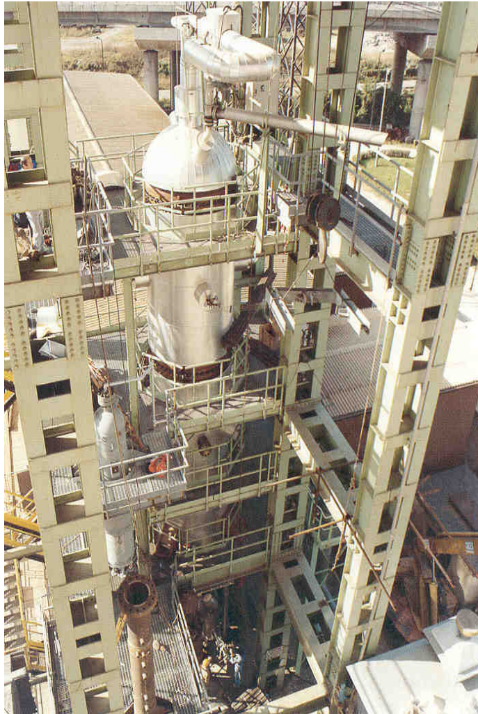
Figura n. 19 - Vessel Impianto GEST-SEP: vista dall'alto
