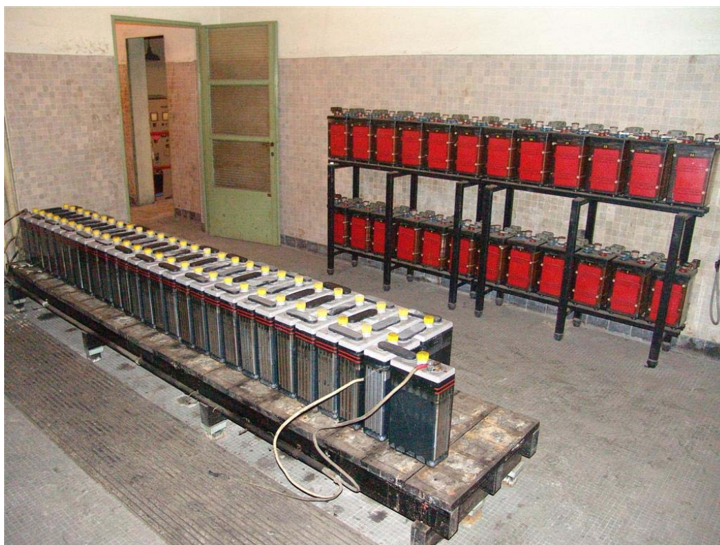
Figura n. 44 - Sala Batterie 110 V
