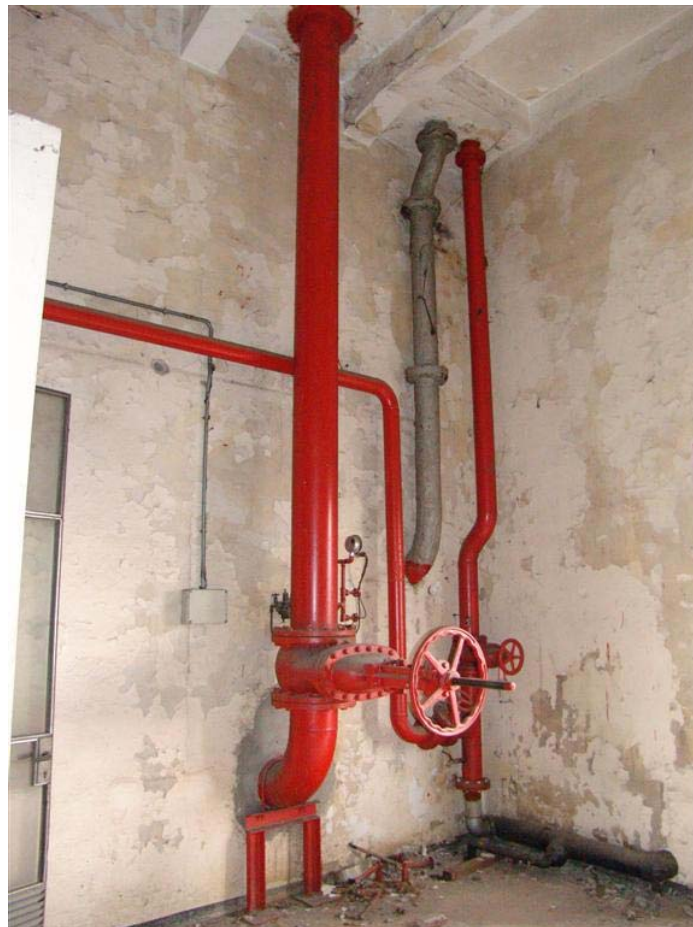
Figura n. 55 - Tubazioni antincendio sottostanti serbatoio pensile
