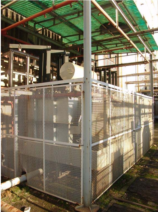
Figura n. 40 - Gruppo di potenza 4MW
