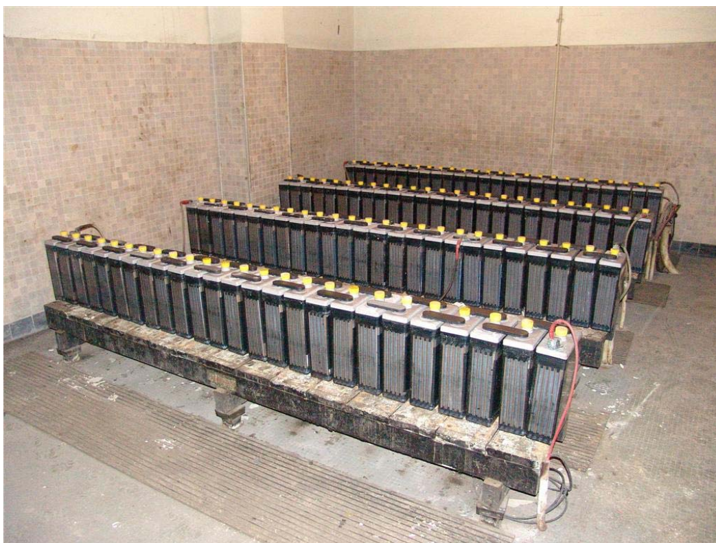
Figura n. 45 - Sala Batterie 220 V
