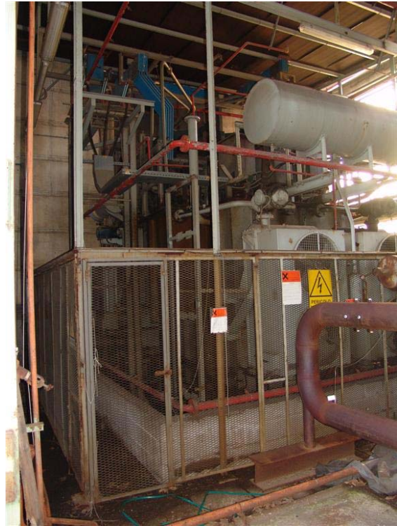
Figura n. 41 - Gruppo di potenza 8MW
