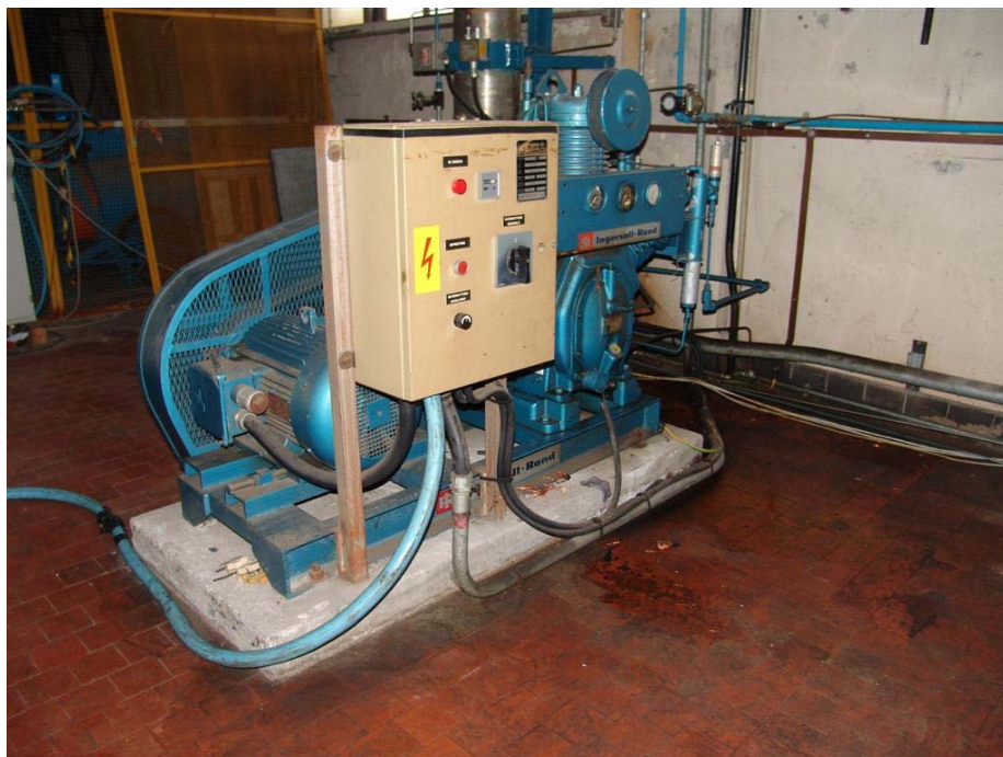
Figura n. 57 - Compressore aria servizi alta pressione (240 bar)
