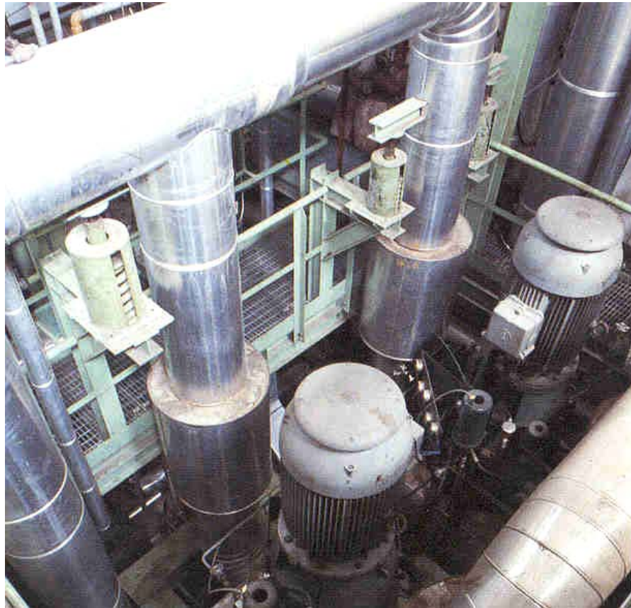
Figura n. 16 - Impianto GEST-GEN: Pompe Primarie
