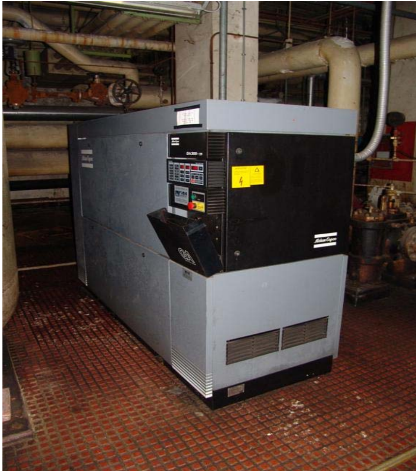
Figura n. 56 - Compressore aria servizi bassa pressione (7 bar)
