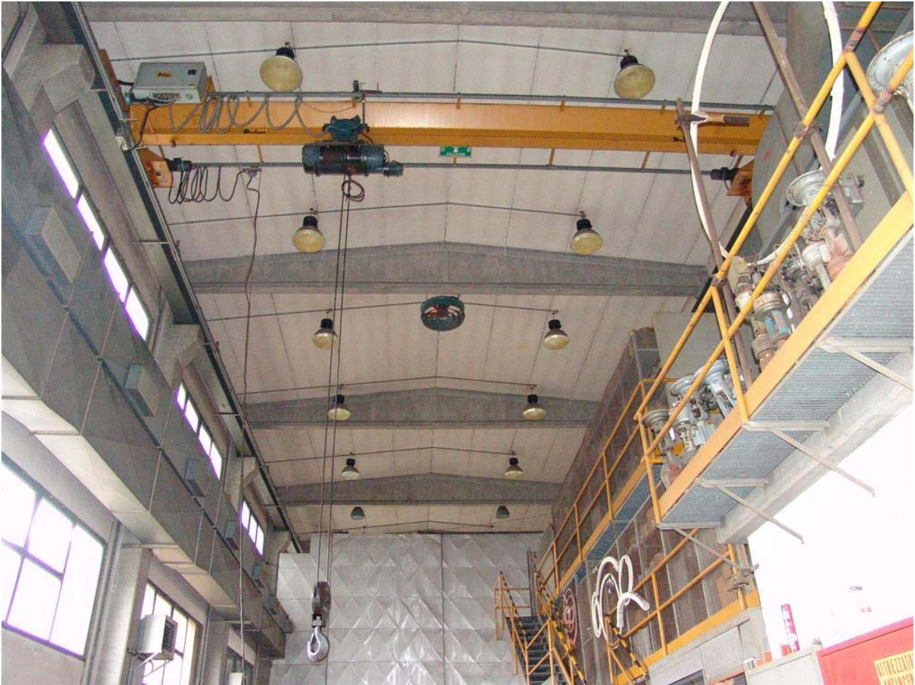
Figura n. 60 - Officina meccanica SIET – Carro-ponte da 5000 kg
