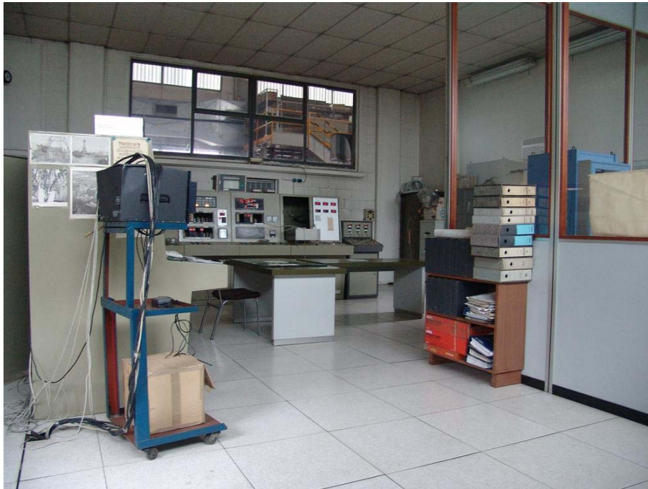
Figura n. 13 - Sala Manovra Impianto GEST
