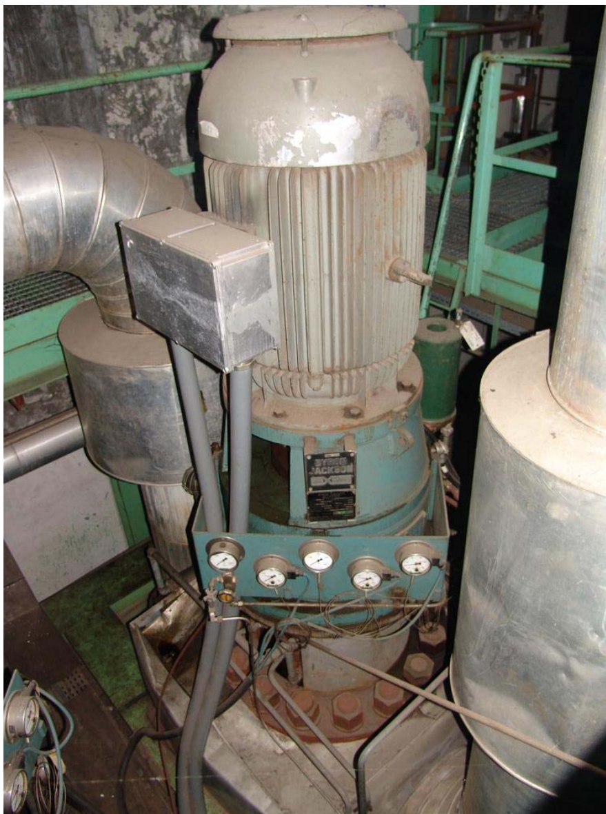
Figura n. 21 - Impianto GEST: Elettro-Pompa Primaria
