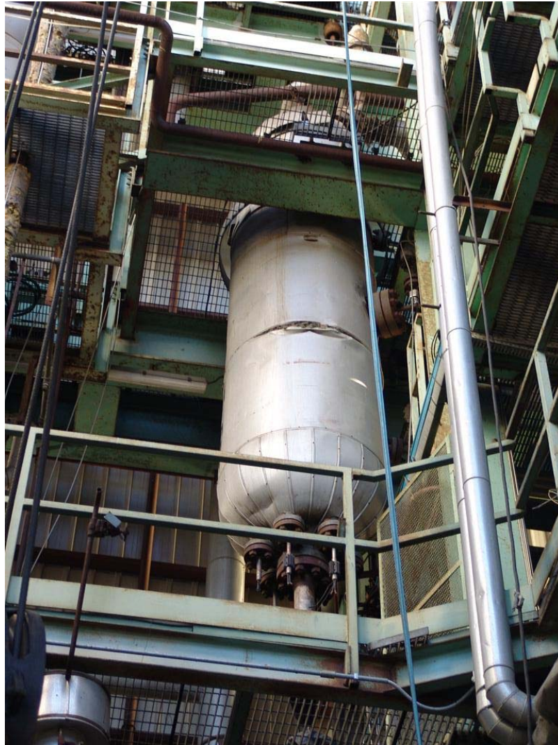
Figura n. 17 - Impianto GEST-GEN: Pressurizzatore Circuito Primario
