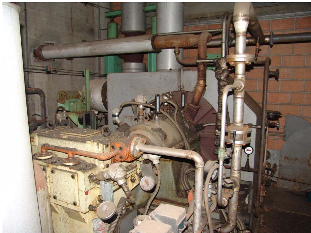
Figura n. 22 - Impianto GEST-SEP: compressore di vapore
