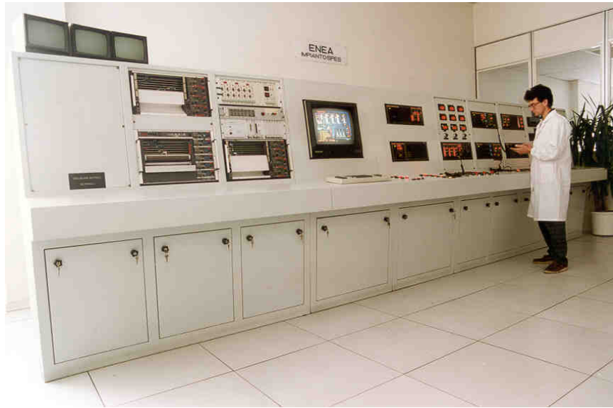
Figura n. 12 - Sala Controllo Impianto SPES
