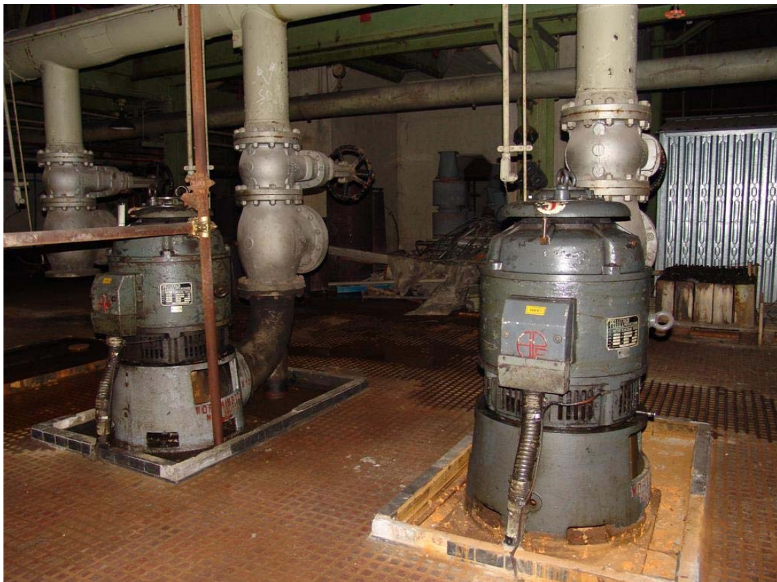
Figura n. 54 - Pompe "acqua servizi" per Grandi Impianti Sperimentali SIET
