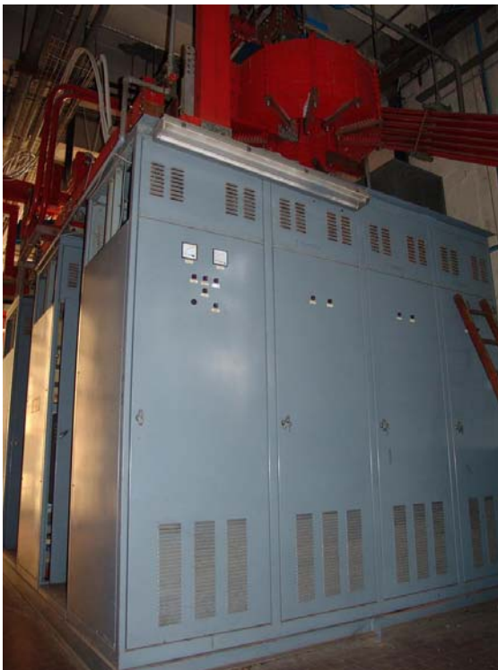
Figura n. 42 Armadio a Tiristori Gruppo di Potenza 4 MW
