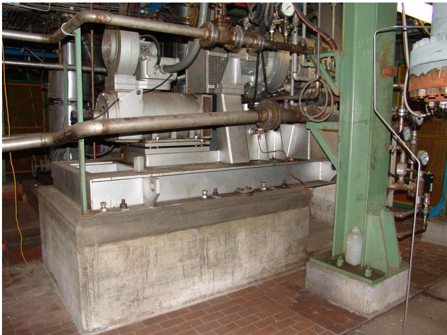
Figura n. 10 - Pompa Primaria Impianto SPES-2
