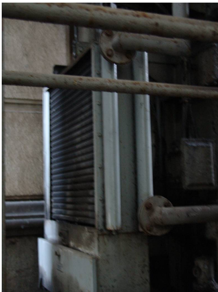
Figura 5 – Sospetto di perdita batteria di scarico trasformatore booster
