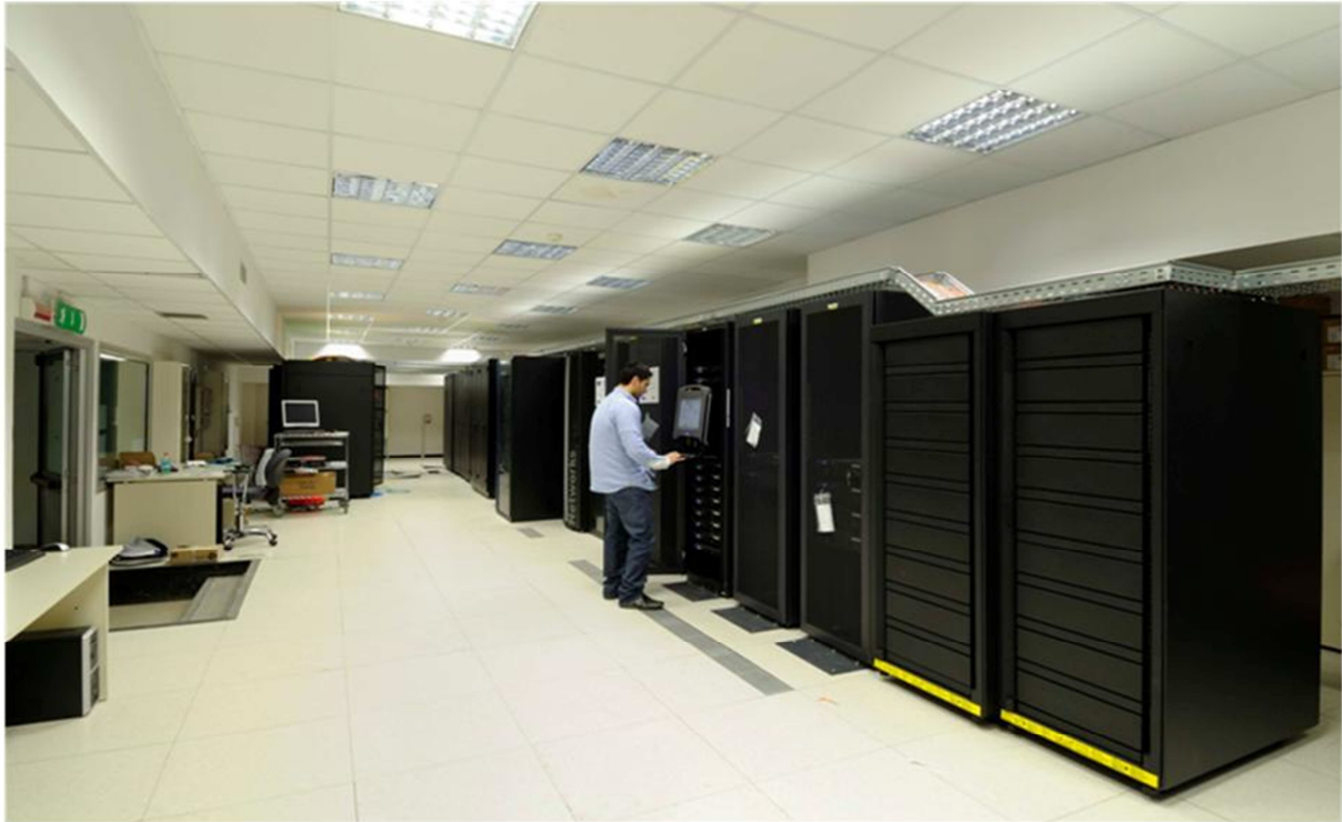
Figura 4 – Sala macchine Infrastruttura supercalcolatore CRESCO
