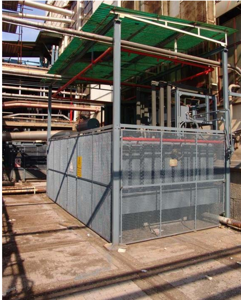
Figura 10 - Gruppo 4 MW dopo la manutenzione
