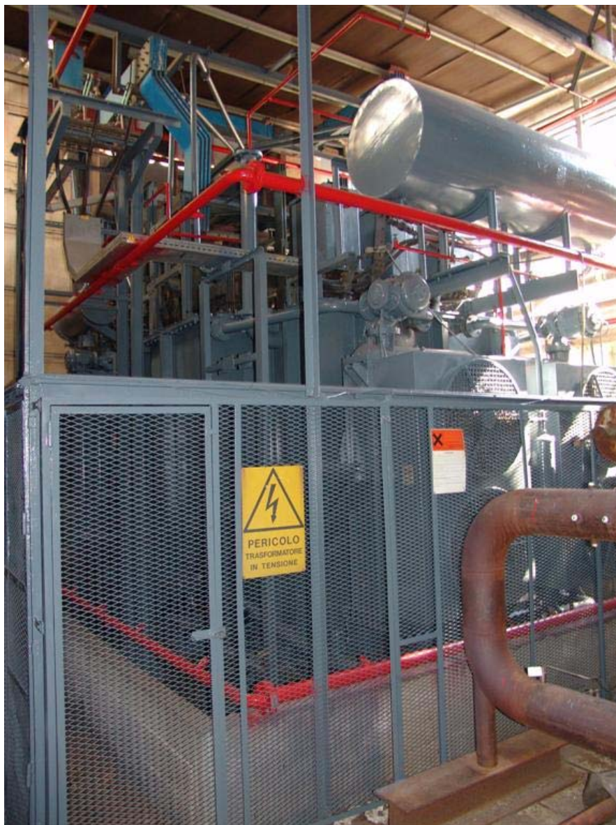
Figura 9 - Gruppo 8 MW dopo la manutenzione
