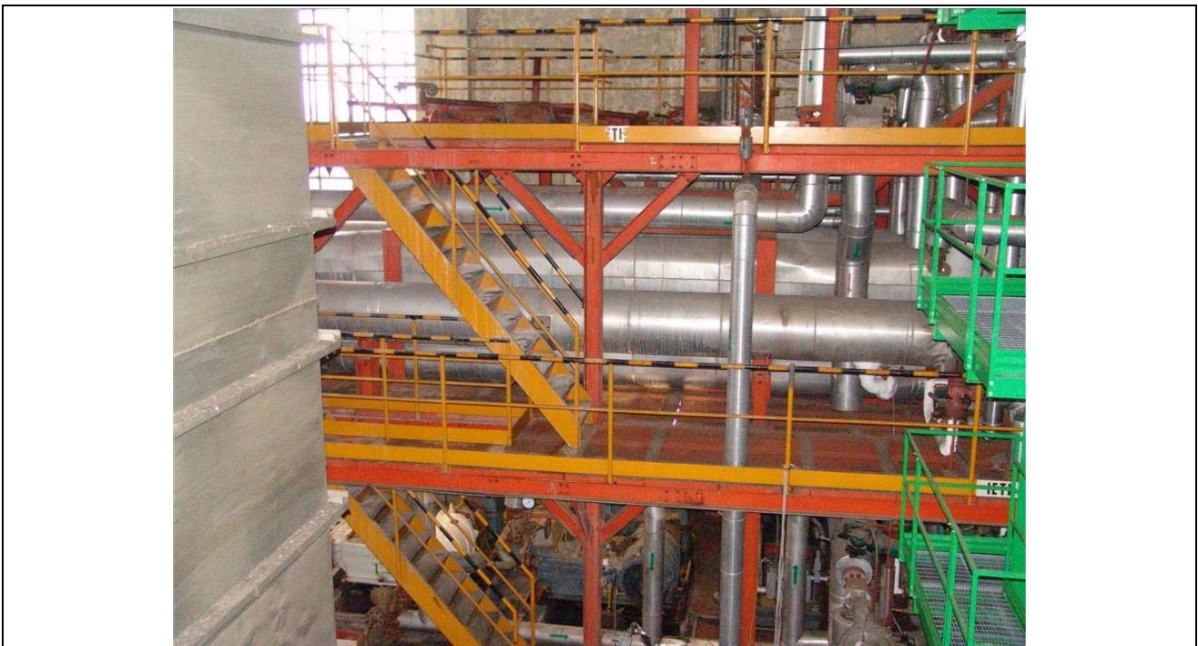
Figura 8 - PRERISCALDATORI ACQUA IMPIANTO IETI-4
