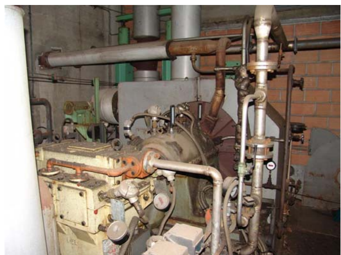
Figura 5 - COMPRESSORE DI VAPORE IMPIANTO GEST-SEP
