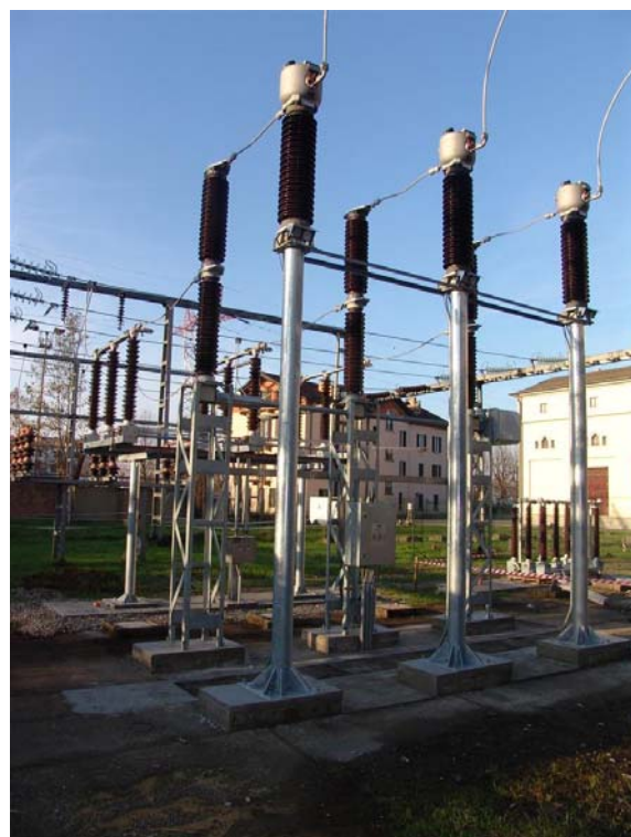
Figura 12 - NUOVI INTERRUTTORI E SEZIONATORI 130 KV
