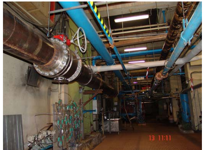
Figura 10 - IMPIANTO VALFRE: PIPING CON VALVOLA IN PROVA
