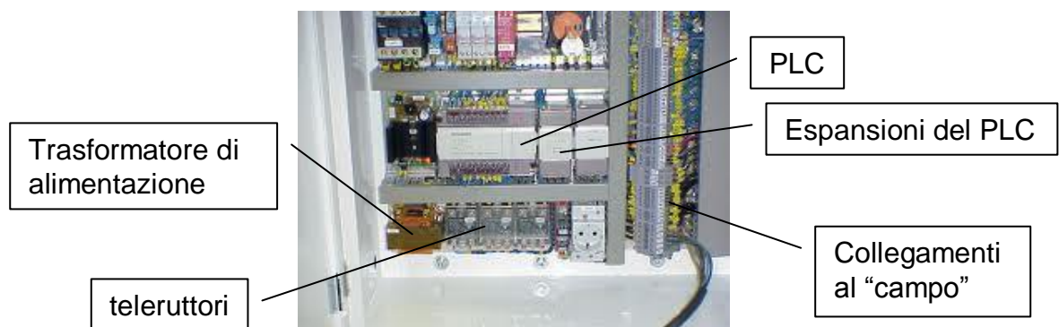
Fig.9: quadro elettrico con PLC
