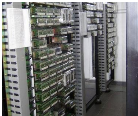
Fig. 8: Sistema di controllo a banchi di relé
