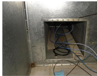
Figura 4 – Particolare del manicotto di collegamento con la camera semianecoica. Lato interno alla camera schermata
