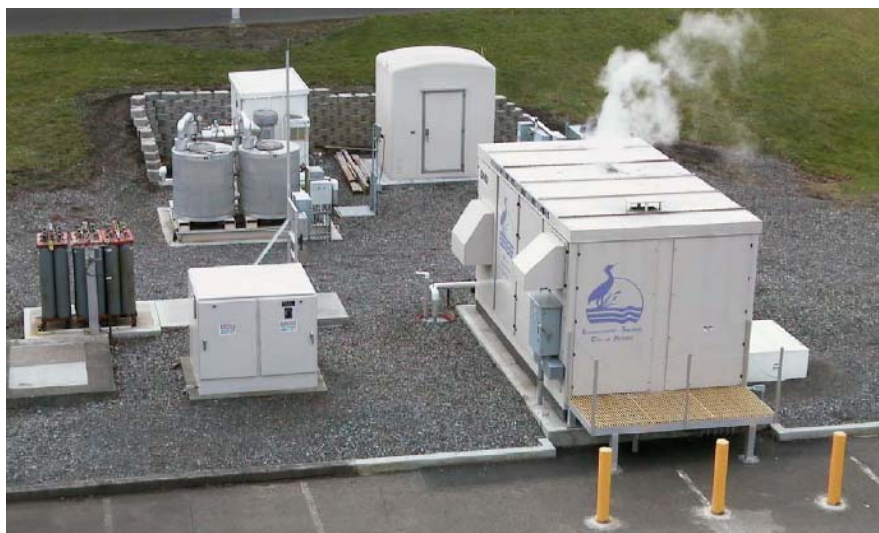
Figura 60 - L'impianto di celle a combustibile da 200 kW. (Fonte: www.eere.energy.gov ).
