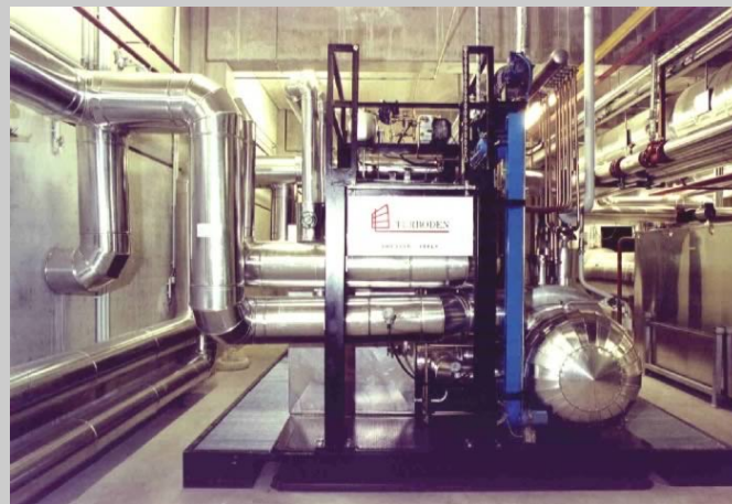
Figura 21 - Il turbogeneratore ORC nella stanza ORC dell'impianto di Admont. Fonte: www.turboden.it .
