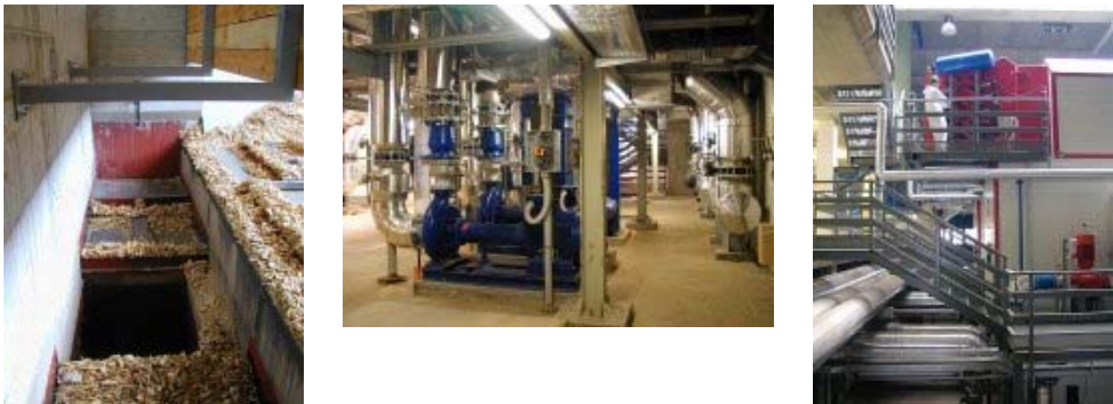
Figura 24 - Particolari della centrale. (Fonte: http://www.teleriscaldamento.valtline.it/tirano/ ).
