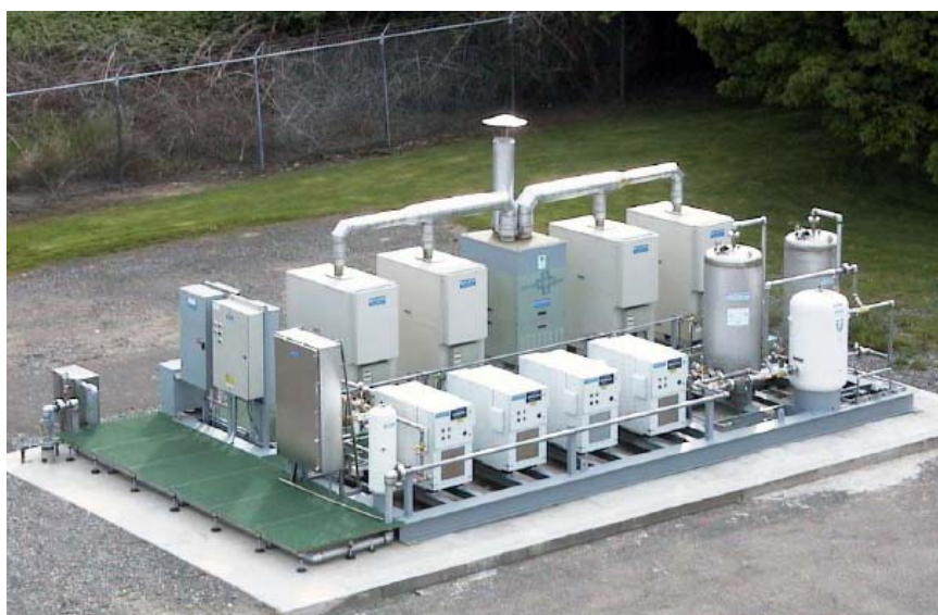
Figura 78 - L'impianto di microturbine. Si tratta di 4 turbine Capstone da 30 kW con centrale di recupero del calore.
