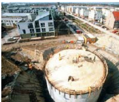
Figura 21 - Serbatoio. Fonte: Claudia Bisceglia, HANNOVER, EDIFICARE SU UN TERRENO AGRICOLO: quando l'antropizzazione del territorio non impoverisce le risorse naturali, L'INDUSTRIA DELLE COSTRUZIONI N° 397 settembre-ottobre 2007.
