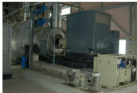
Figura 33 - Generatore elettrico. (Fonte: www.fti.bz/it/informazioni/impianto.html ).
