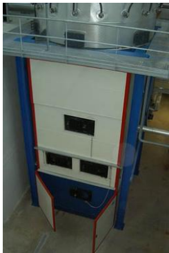
Figura 30 - Caldaia 10 MW. (Fonte: www.fti.bz/it/informazioni/impianto.html ).
