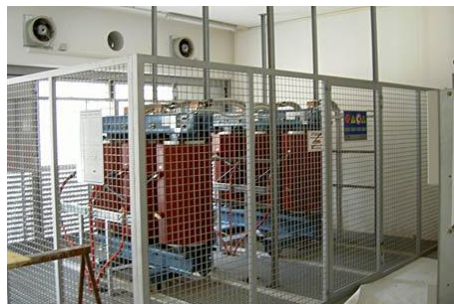
Figura 32 - Stazione di trasformazione. (Fonte: www.fti.bz/it/informazioni/impianto.html ).
