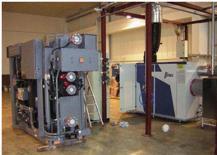
Figura 66 – Immagine delle microturbine Turbec.
