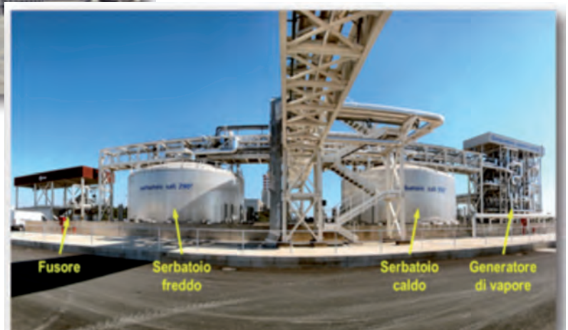
Impianto Archimede (Priolo Gargallo SR)
