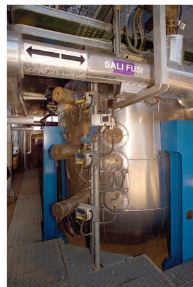
Serbatoio presente nell'impianto sperimentale PCS
