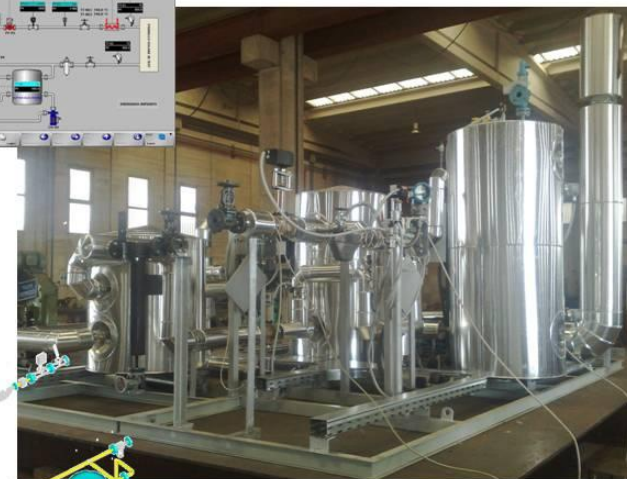
Foto dell'impianto assemblato
