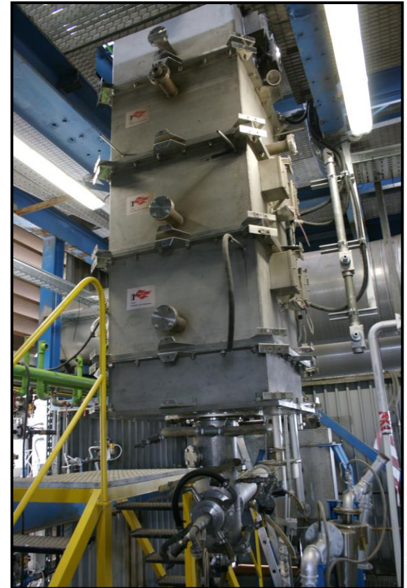
Impianto IPFR (ENEL/IFRF)
