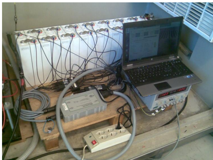
Fig. 33 – BMS n. 3 in esercizio
