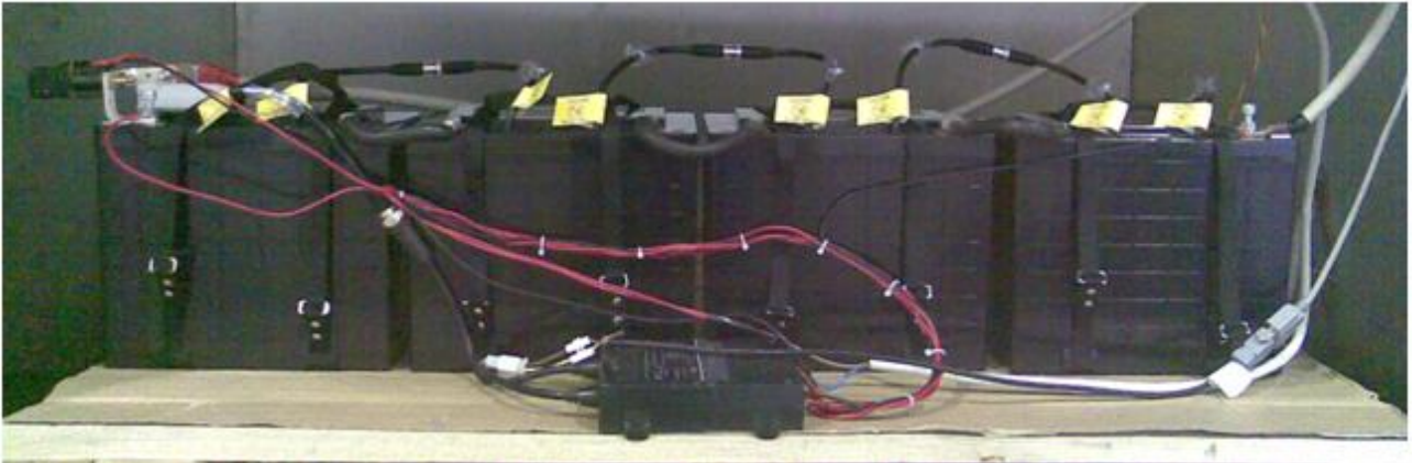
Figura 36 - Sistema batterie 48V – 100 Ah
