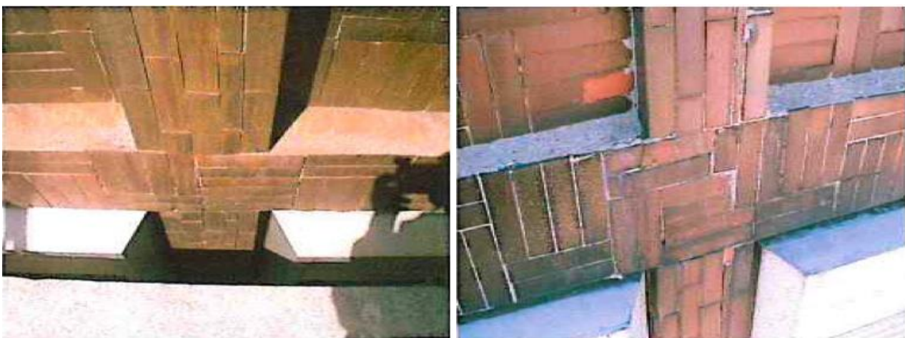
Figura 13. Foto del rivestimento in gres delle facciate dell'edificio tratte dall'indagine diagnostica.
