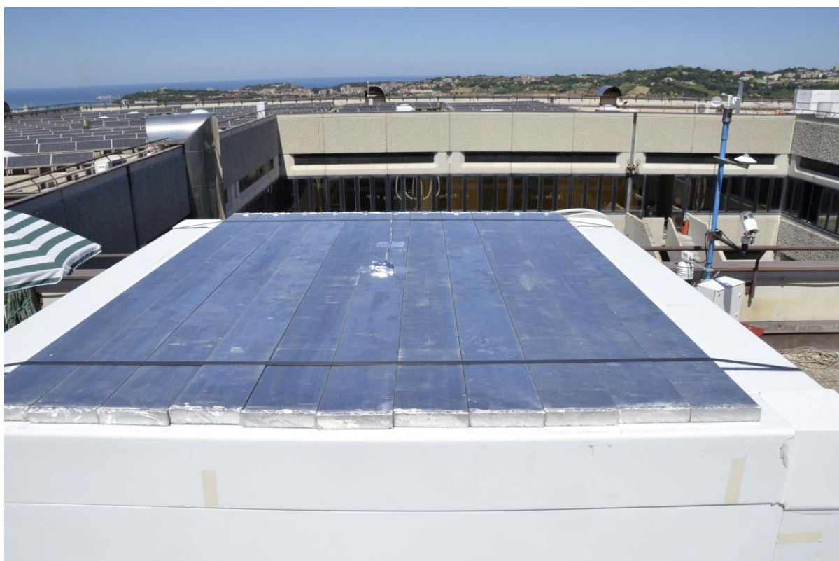
Figura 31 immagine della copertura con gli elementi contenenti PCM
