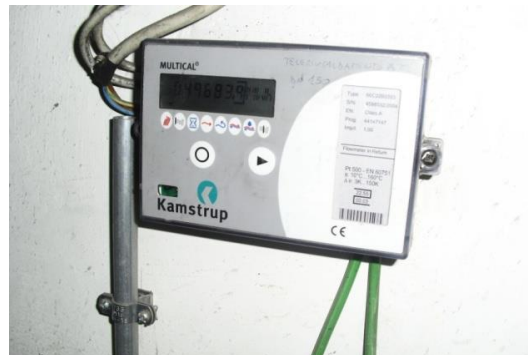
Figura 28: Misuratore di calore nr.9
