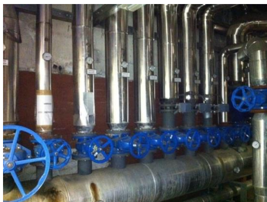
Figura 20: Collettore di mandata dell'impianto
