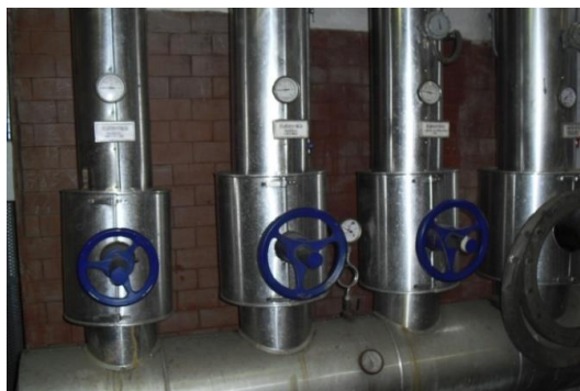
Figura 25: Collettore circuito palazzina uffici
