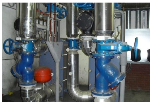
Figura 26: Scambiatori di calore lato circuito di teleriscaldamento
