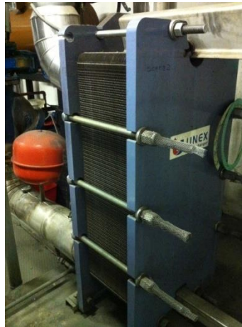
Figura 22: Scambiatore di calore lato circuito palazzina uffici
