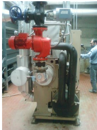
Figura 16: Gruppo frigorifero a compressione TRANE RTWB 214
