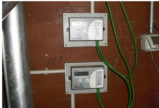
Figura 23: Misuratori nr. 10 e 11
