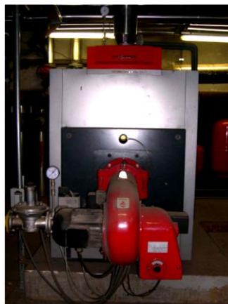
Figura 11: Caldaia Viessmann Vitocrossal 300 tipo CR3
