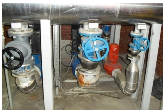
Figura 27: Pompe del circuito di teleriscaldamento
