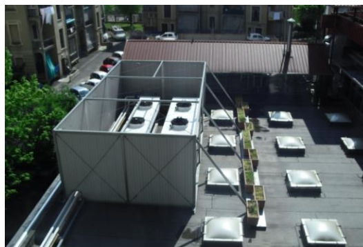
Figura 29: Dissipatore aerotermo del cogeneratore
