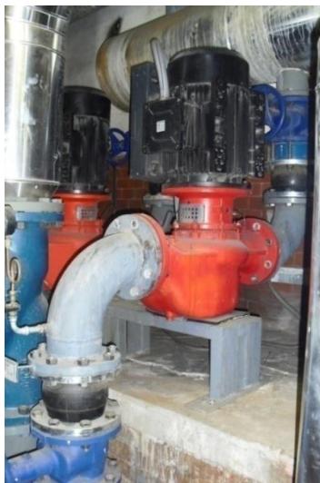
Figura 21: Pompe sul collettore di mandata
