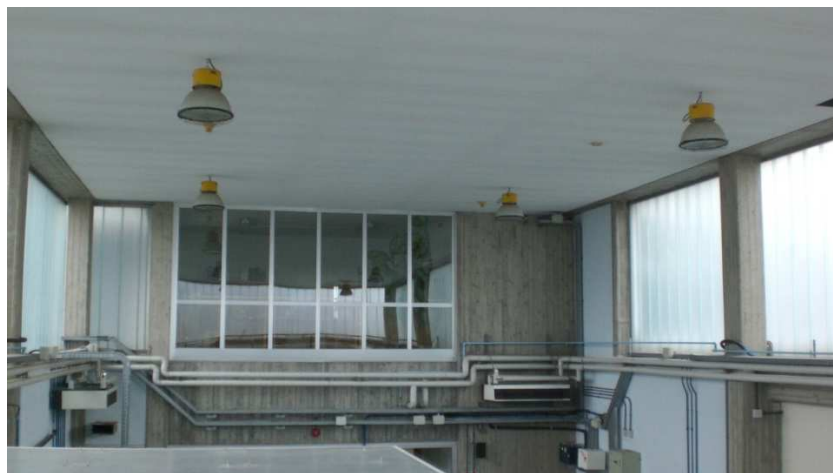
Figura 5: Vista dell'impianto di illuminazione esistente
